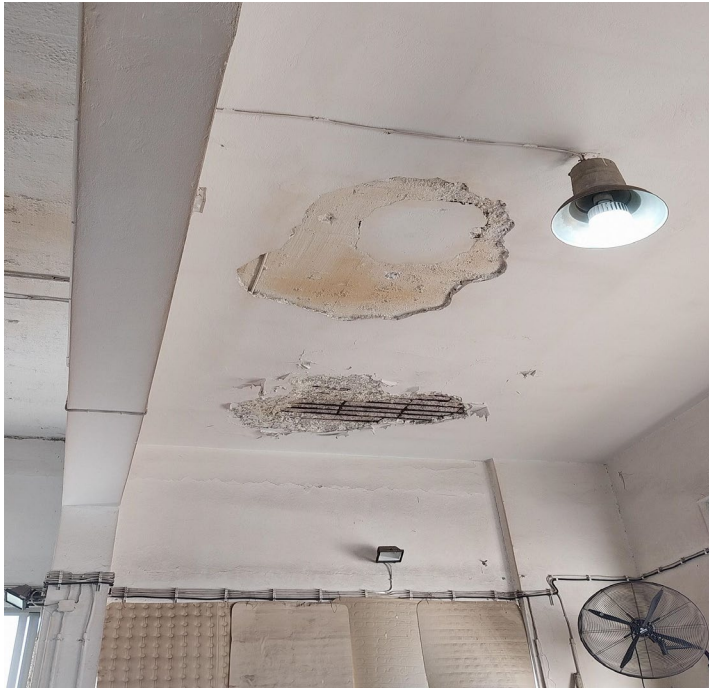
Εικόνα 1: Αποκόλληση επιχρισμάτων οροφής
