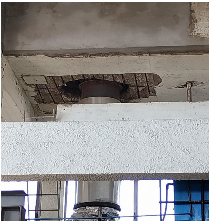
Εικόνα 2: Αποκόλληση επιχρισμάτων με αποδιοργάνωση σκυροδέματος
