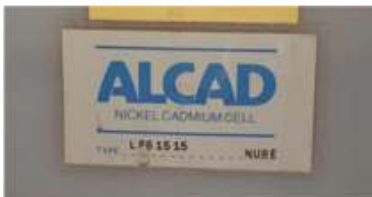
Φωτογραφία 2: Πινακίδα εγκατεστημένων στοιχείων
