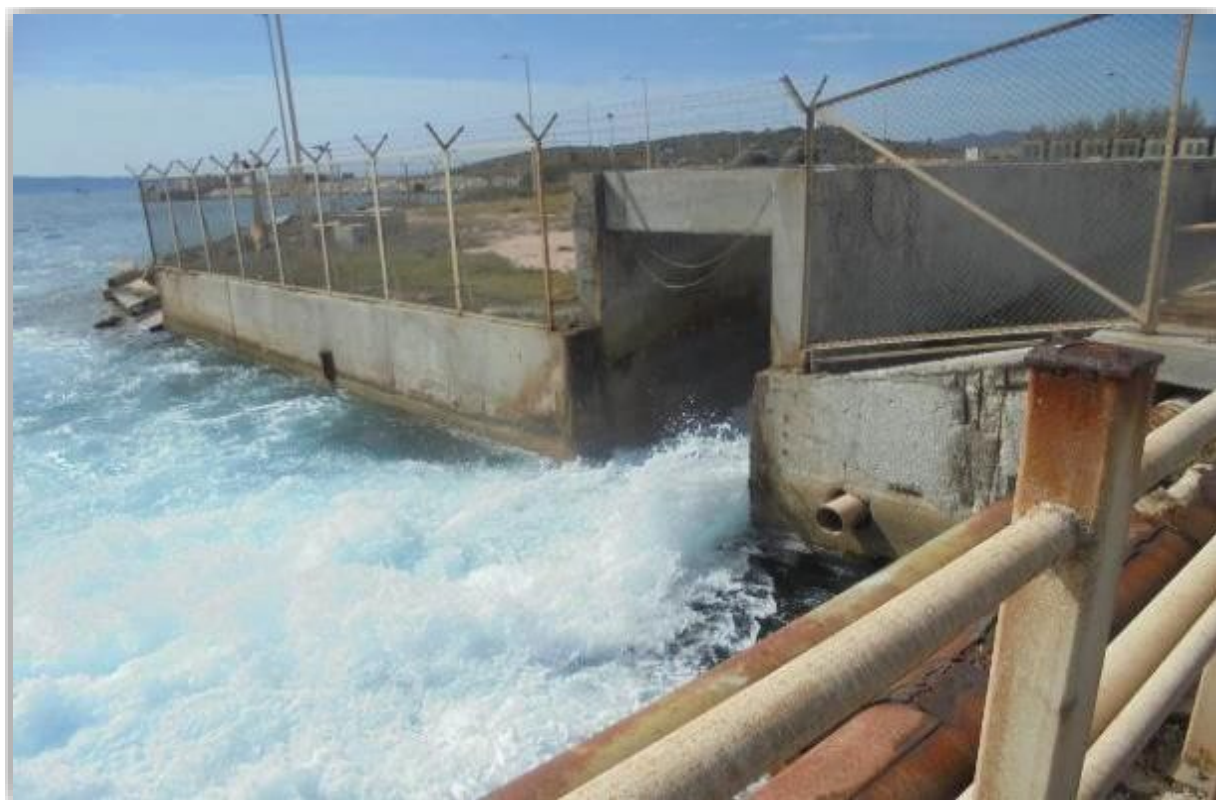
Εικόνες 6 & 7: Εκβολή νερού ψύξης Μονάδας V
