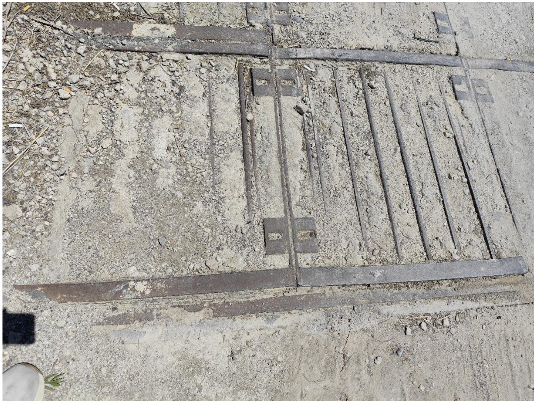
Εικόνα 4 Άποψη ενός ηλεκτρομηχανολογικού καναλιού εξωτερικού χώρου.
