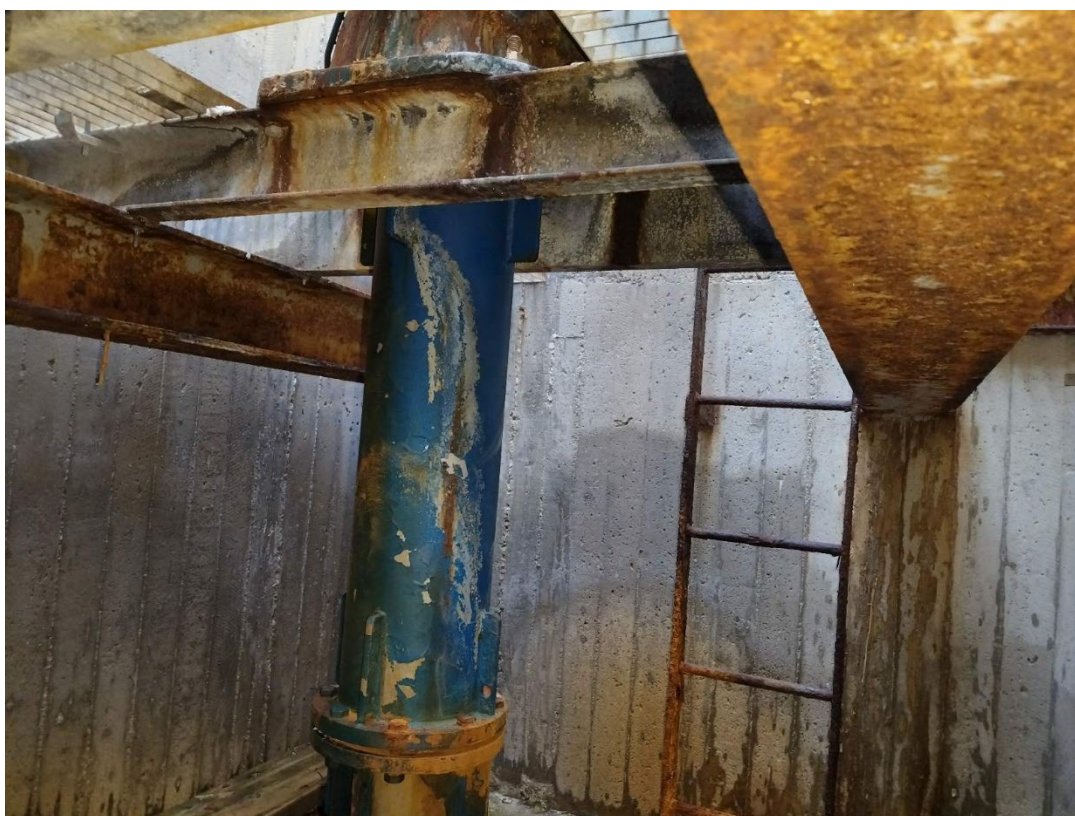
Φωτογραφία 40 Άποψη κατάστασης μεταλλικής κατασκευής στήριξης τρίδημου αντλητικού ζεύγους 260m 3 /h εντός φρεατίου [3].
