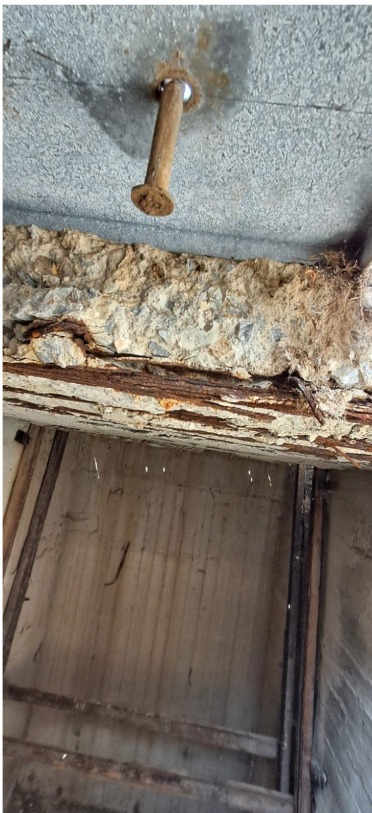
Φωτογραφία 26 Κοντινή άποψη κατάστασης σιδηρού οπλισμού και σκυροδέματος οροφής (τμήμα 1β) φρεατίου ηρεμίας και φύκων [1]. Θέση έδρασης ελασμάτων καλύμματος οροφής.
