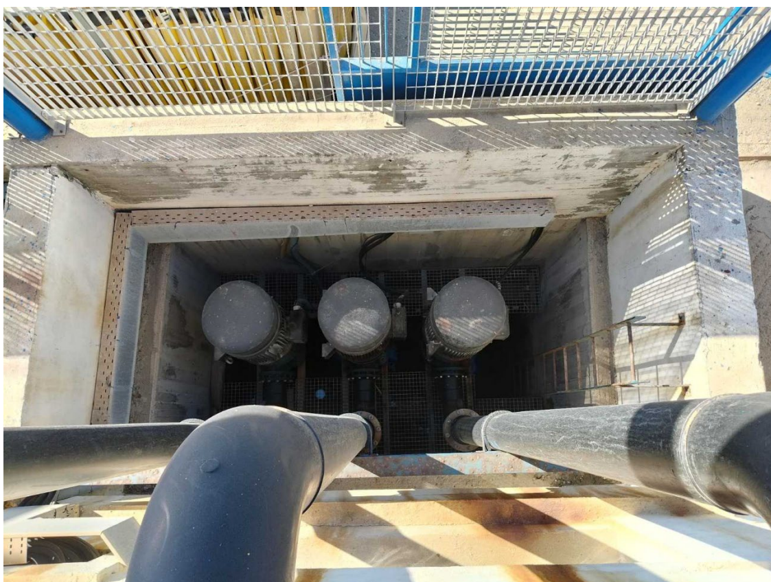
Φωτογραφία 42 Άποψη φρεατίου άντλησης [3] τρίδημου αντλητικού ζεύγους 260m 3 /h.
