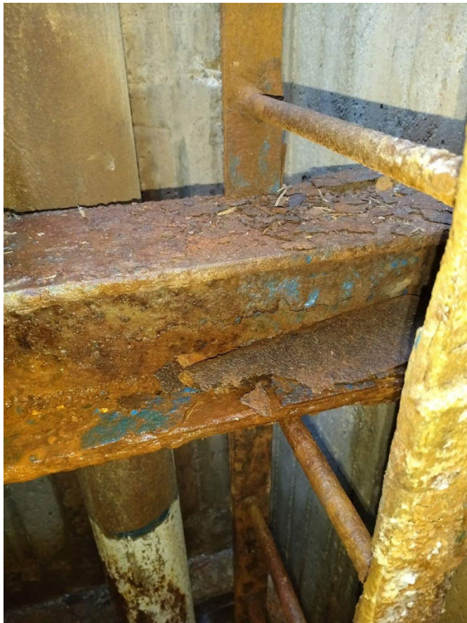
Φωτογραφία 35 Αποψη κατάστασης μεταλλικής κατασκευής στήριξης τρίδημου αντλητικού ζεύγους 420m 3 /h και κατακόρυφης κλίμακας, εντός φρεατίου [2].
