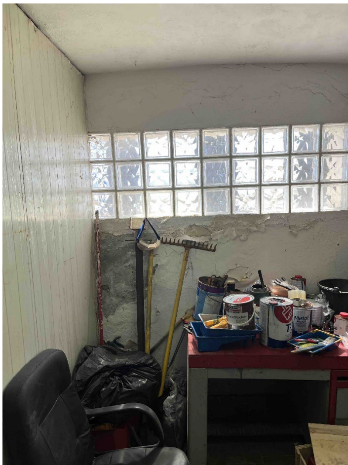
Φωτογραφία 60 Αποψη εσωτερικής κατάστασης επιχρισμάτων και στοιχείων σκυροδέματος του αντλιοστασίου θάλασσας.
