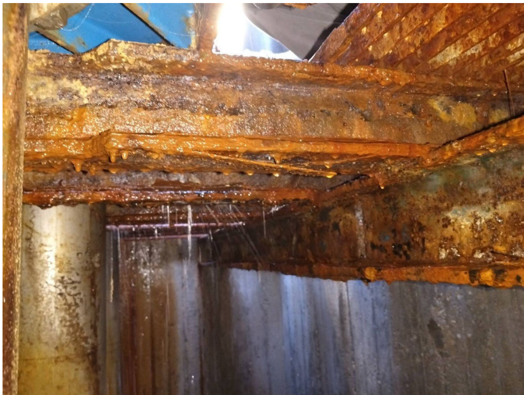
Φωτογραφία 32 Αποψη κατάστασης μεταλλικής κατασκευής στήριξης τρίδημου αντλητικού ζεύγους 420m 3 /h εντός φρεατίου [2].
