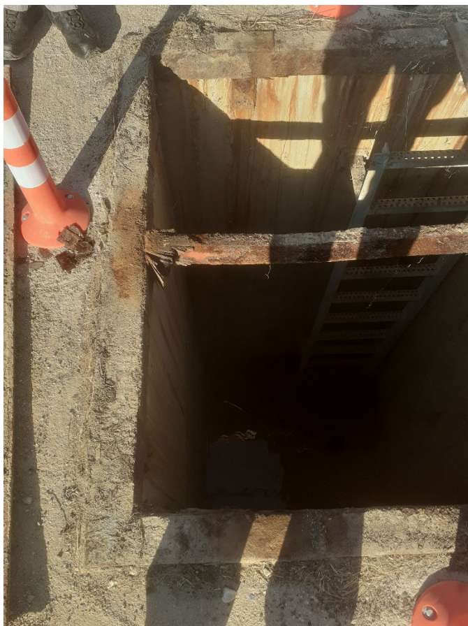
Φωτογραφία 48 Κοντινή άποψη ενδιάμεσου φρεατίου [4]. Οξειδώσεις και παραμόρφωση μεταλλικού φορέα στήριξης ελάσματος κάλυψης.
