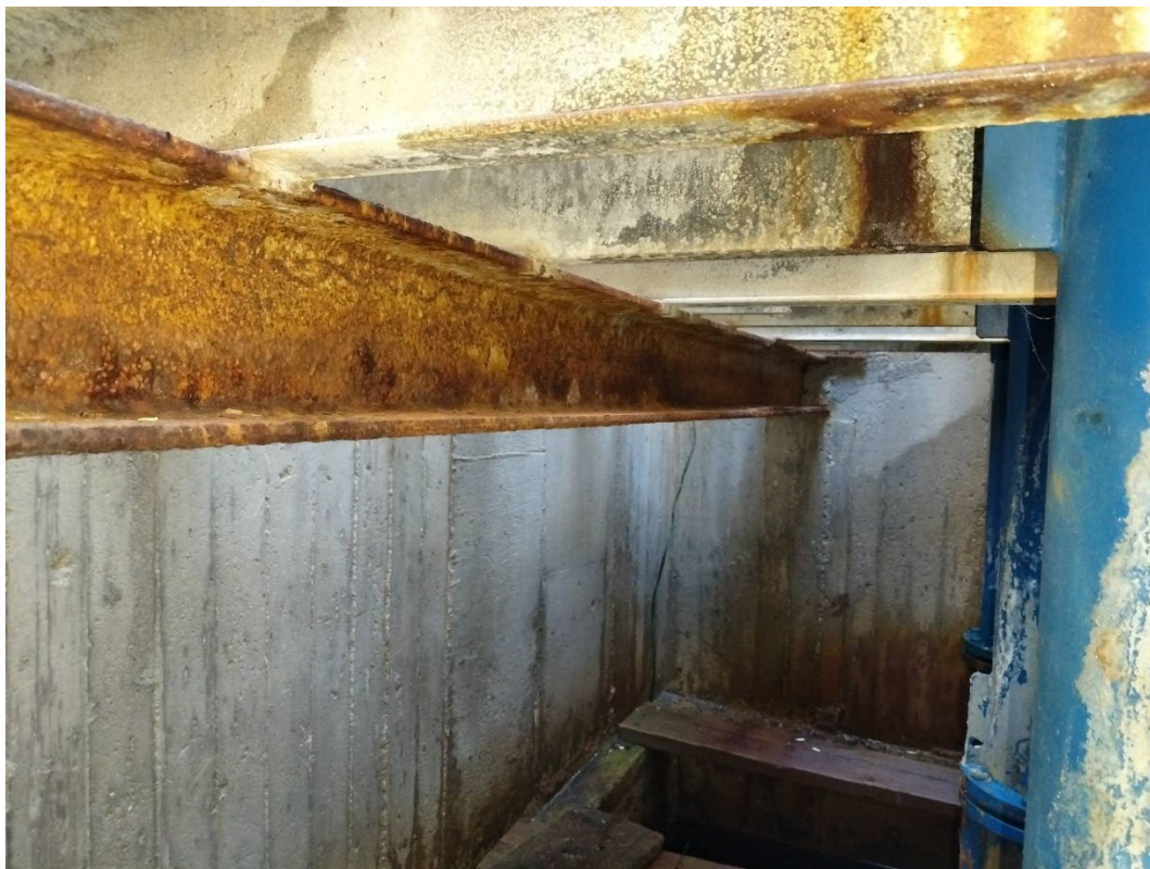
Φωτογραφία 39 Άποψη κατάστασης μεταλλικής κατασκευής στήριξης τρίδημου αντλητικού ζεύγους 260m 3 /h εντός φρεατίου [3].
