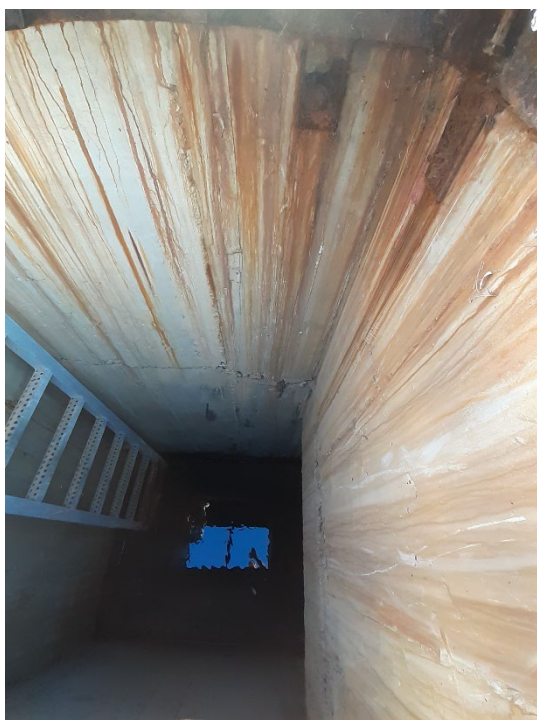
Φωτογραφία 49 Κοντινή άποψη στοιχείων σκυροδέματος ενδιάμεσου φρεατίου [4]. Περιορισμένη εμφάνιση οξειδώσεων και αστοχιών. Έλεγχος συνόλου επιφανειών.
