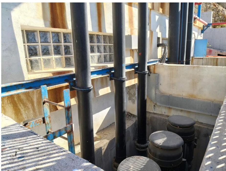
Φωτογραφία 44 Άποψη φρεατίου άντλησης [3] τρίδημου αντλητικού ζεύγους 260m 3 /h.
