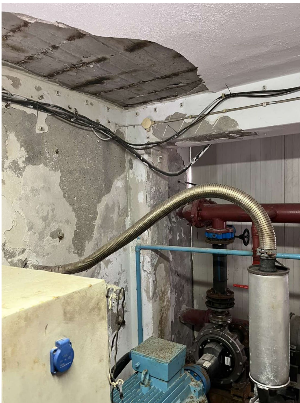
Φωτογραφία 56 Άποψη εσωτερικής κατάστασης επιχρισμάτων και στοιχείων σκυροδέματος του αντλιοστασίου θάλασσας.
