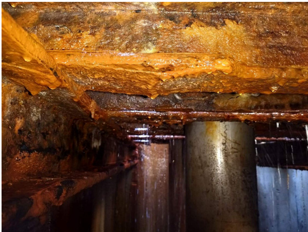
Φωτογραφία 34 Αποψη κατάστασης μεταλλικής κατασκευής στήριξης τρίδημου αντλητικού ζεύγους 420m 3 /h εντός φρεατίου [2].
