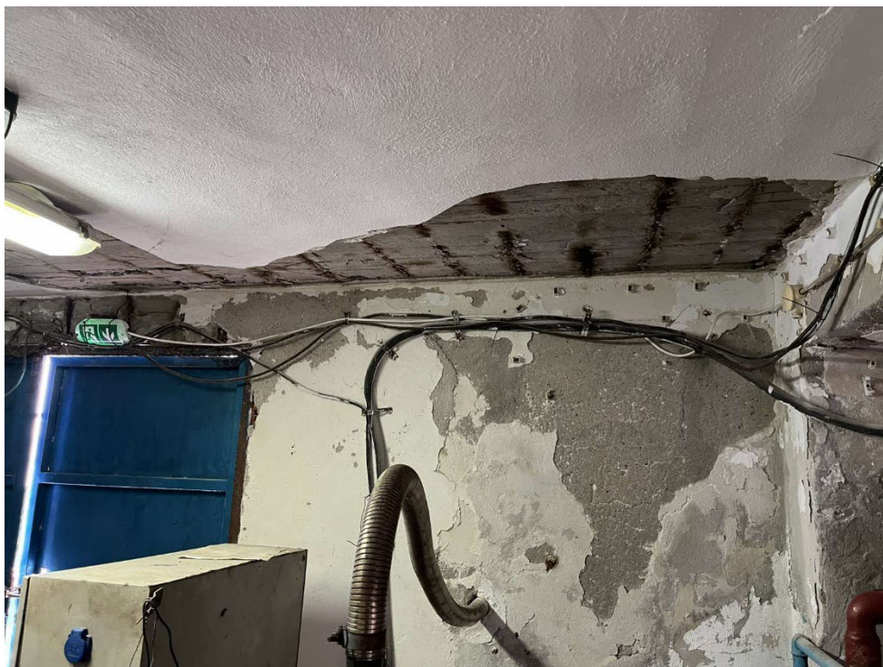
Φωτογραφία 59 Αποψη εσωτερικής κατάστασης επιχρισμάτων και στοιχείων σκυροδέματος του αντλιοστασίου θάλασσας.
