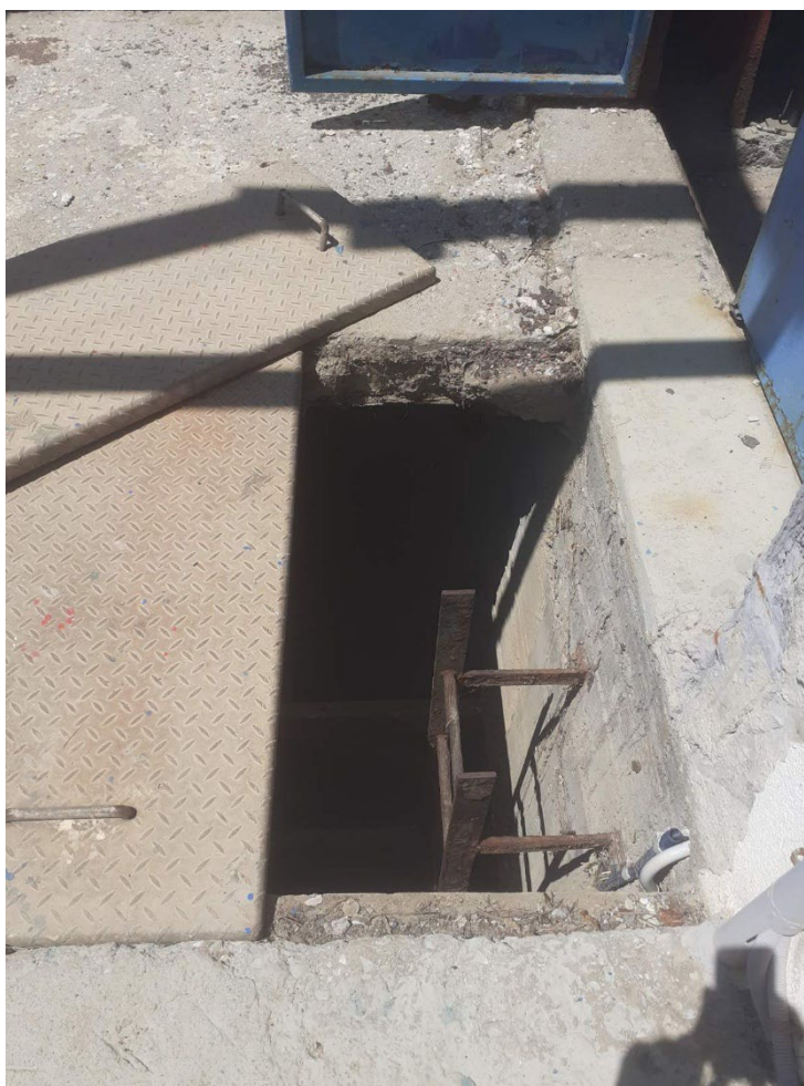
Φωτογραφία 28 Κοντινή άποψη κατάστασης σιδηρού οπλισμού και σκυροδέματος οροφής (τμήμα 1β) φρεατίου ηρεμίας και φύκων [1]. Διακρίνεται η αστοχία της υποδοχής στήριξης -πατούρας του ελάσματος καλύμματος.
