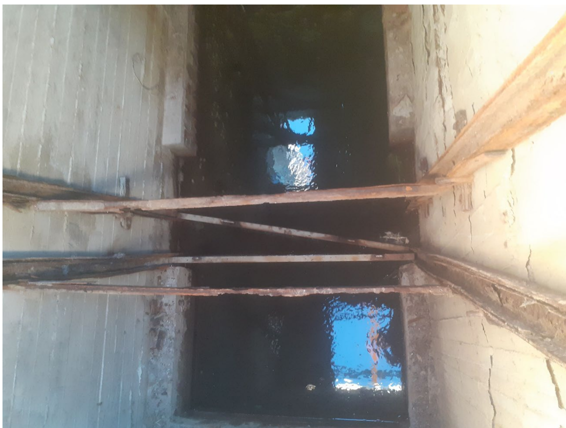
Φωτογραφία 24 Κοντινή άποψη διάταξης του συστήματος φίλτρων και των οδηγών φρεατίου ηρεμίας και φύκων [1]. Διακρίνεται η αστοχία των οδηγών και η παραλληλότητα των φίλτρων.
