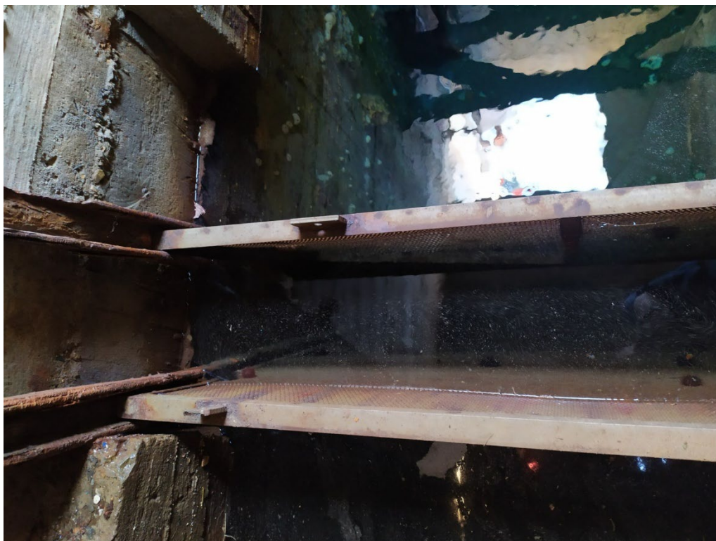
Φωτογραφία 23 Κοντινή άποψη διάταξης του συστήματος φίλτρων και των οδηγών φρεατίου ηρεμίας και φύκων [1].
