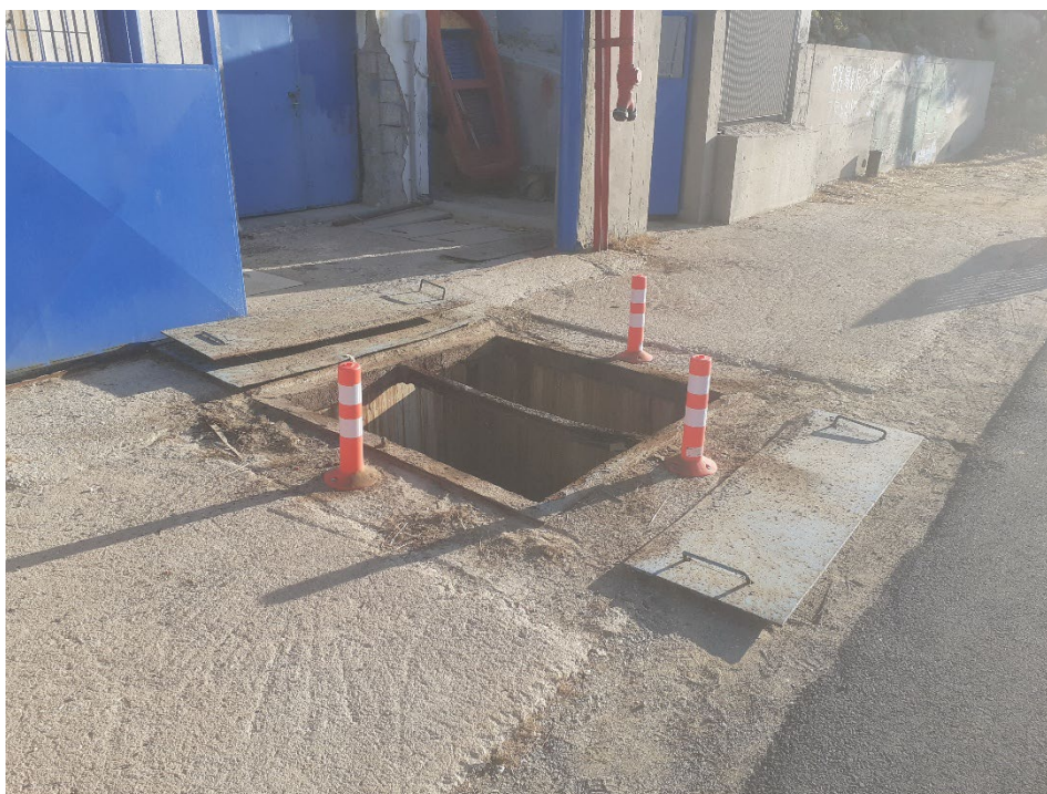
Φωτογραφία 46 Θέση ενδιάμεσου φρεατίου [4].
