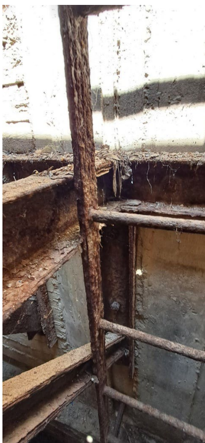
Φωτογραφία 31 Κοντινή άποψη κατάστασης βοηθητικής κατασκευής (τμήμα 1γ) καθώς και κατακόρυφης κλίμακας φρεατίου ηρεμίας και φύκων [1].
