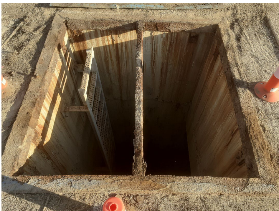
Φωτογραφία 47 Κοντινή άποψη ενδιάμεσου φρεατίου [4]. Οξειδώσεις και παραμόρφωση μεταλλικού φορέα στήριξης ελάσματος κάλυψης.
