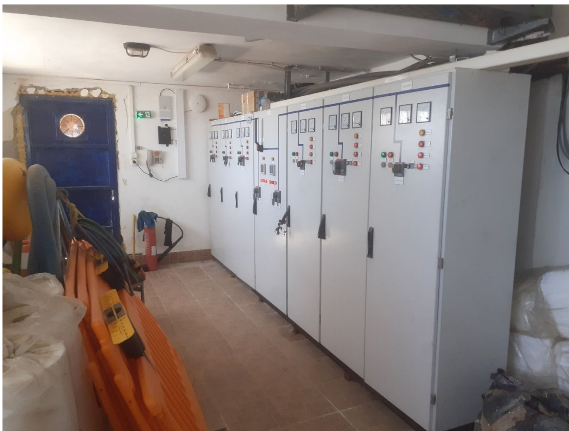
Φωτογραφία 61 Άποψη εσωτερικής κατάστασης επιχρισμάτων και στοιχείων σκυροδέματος του αντλιοστασίου θάλασσας.
