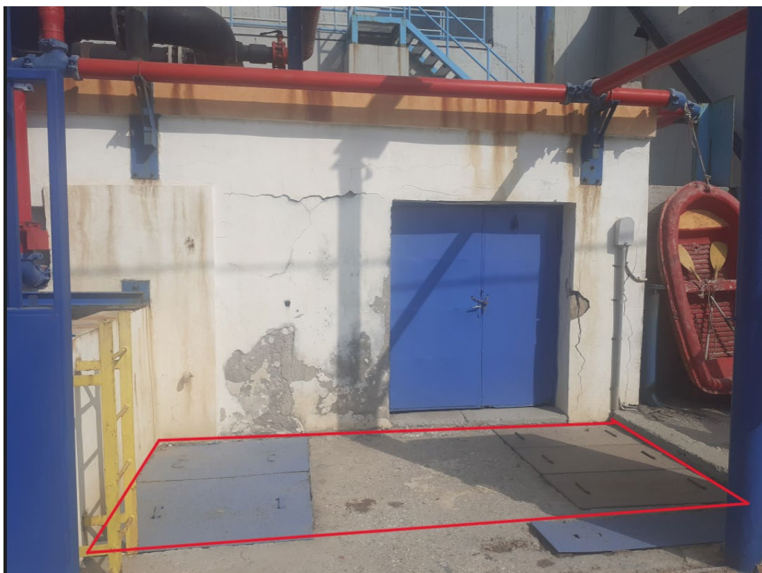
Φωτογραφία 5 Άποψη οροφής φρεατίου ηρεμίας και φύκων.
