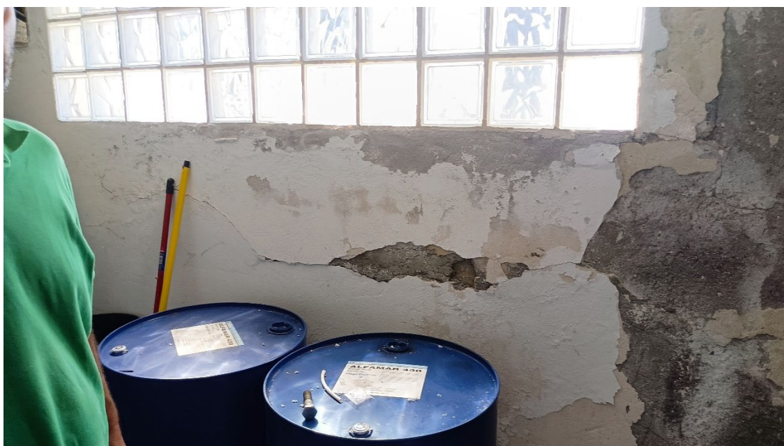
Φωτογραφία 62 Άποψη εσωτερικής κατάστασης επιχρισμάτων και στοιχείων σκυροδέματος του αντλιοστασίου θάλασσας.
