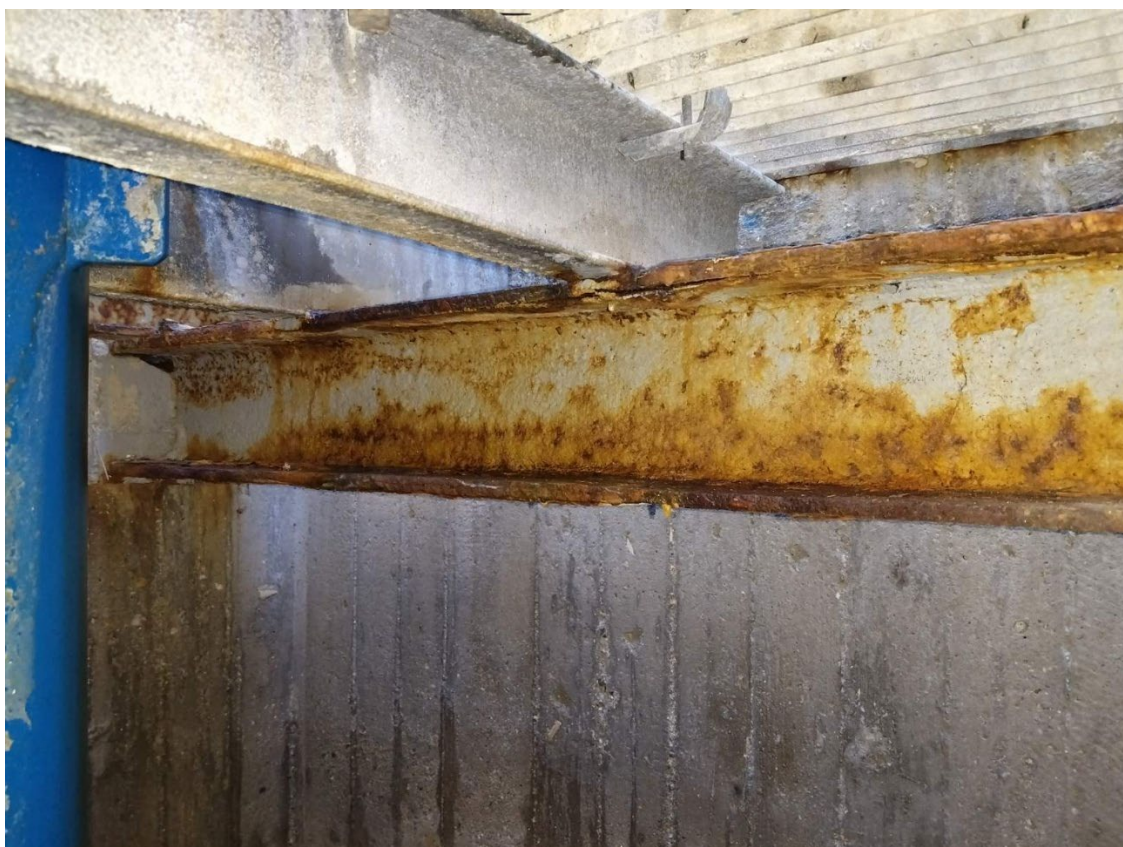
Φωτογραφία 41 Άποψη κατάστασης μεταλλικής κατασκευής στήριξης τρίδημου αντλητικού ζεύγους 260m 3 /h εντός φρεατίου [3].
