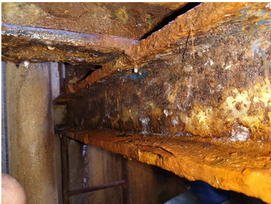
Φωτογραφία 33 Αποψη κατάστασης μεταλλικής κατασκευής στήριξης τρίδημου αντλητικού ζεύγους 420m 3 /h εντός φρεατίου [2].
