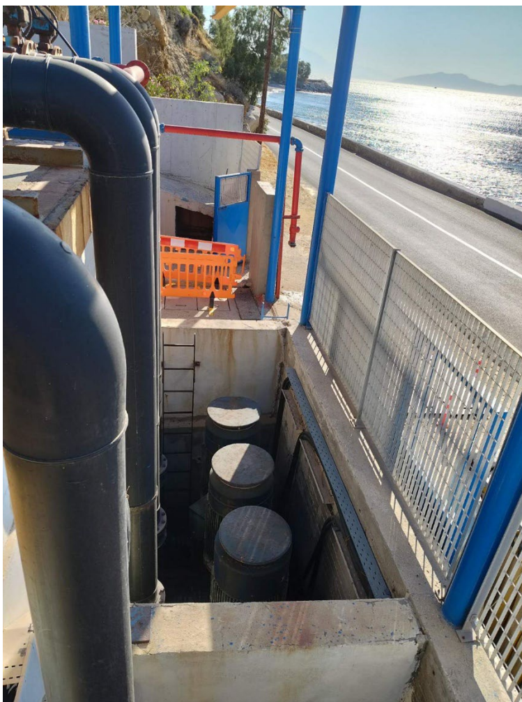
Φωτογραφία 37 Άποψη φρεατίου άντλησης [2] τρίδημου αντλητικού ζεύγους 420m 3 /h.
