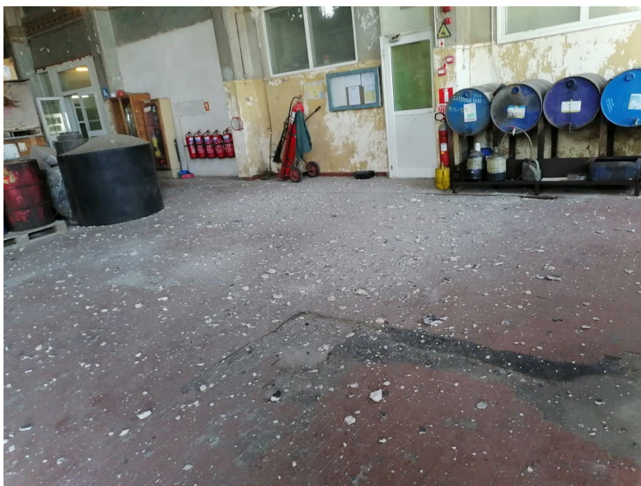
Εικόνα 14 Ενδεικτική κατάσταση: Πτώση αποσαθρωμένων τμημάτων επικάλυψης σκυροδέματος σε κεντρικό σημείο του μηχανοστασίου.
