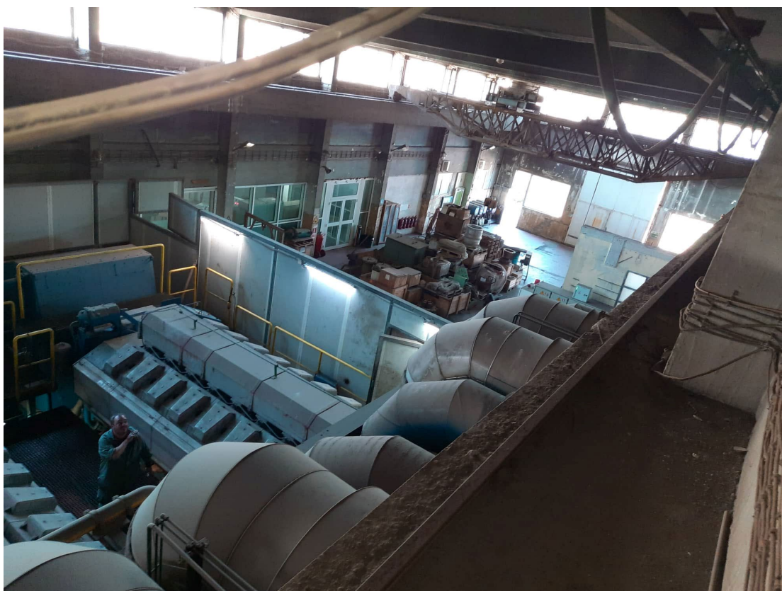
Εικόνα 17 Πανοραμική άποψη μηχανολογικού εξοπλισμού που χρήζει προστασίας.
