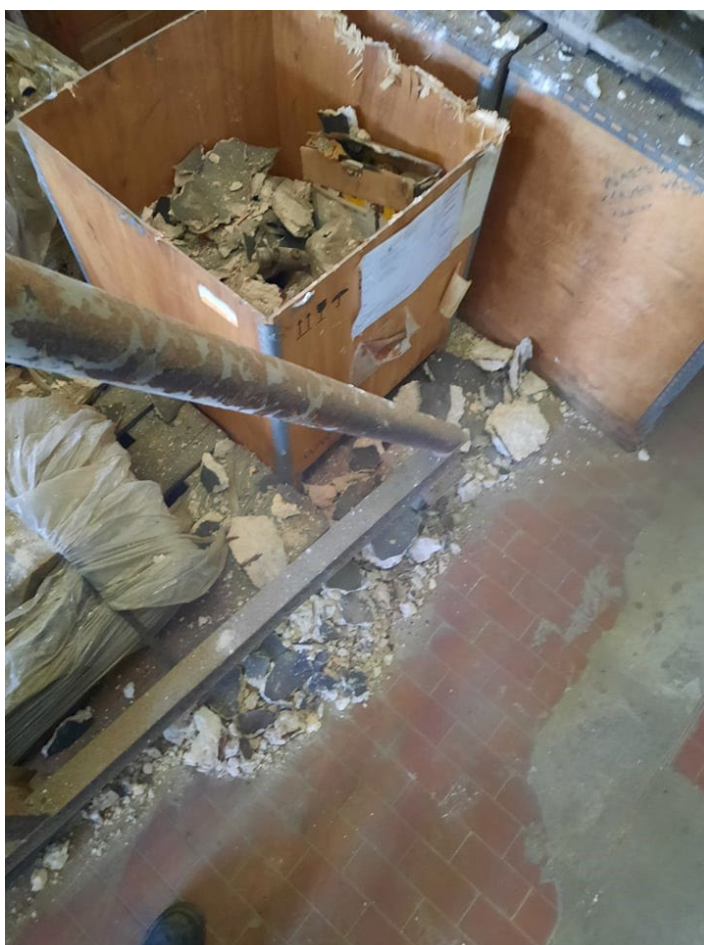
Εικόνα 15 Ενδεικτική κατάσταση: Πτώση αποσαθρωμένων τμημάτων επικάλυψης σκυροδέματος σε κεντρικό σημείο του μηχανοστασίου.
