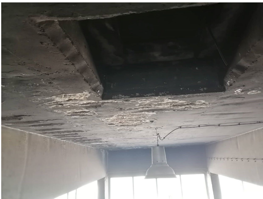
Εικόνα 11 Κοντινότερη άποψη κάτω παρειάς πλάκας οροφής, σε διάφορα τμήματα.
