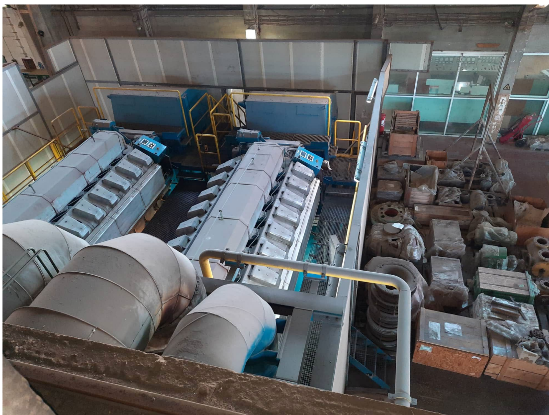
Εικόνα 16 Πανοραμική άποψη μηχανολογικού εξοπλισμού που χρήζει προστασίας.
