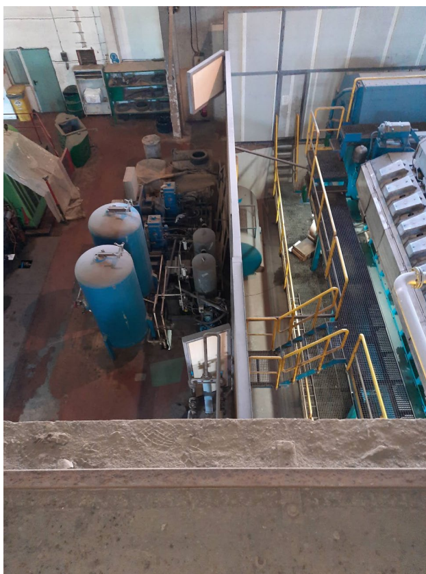
Εικόνα 18 Πανοραμική άποψη μηχανολογικού εξοπλισμού που χρήζει προστασίας.
