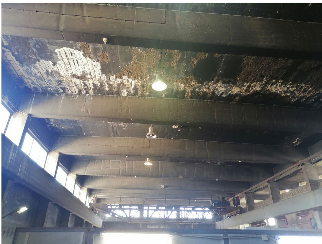
Εικόνα 7 Ευρύτερη άποψη της κάτω παρειάς πλάκας οροφής ισογείου Μηχανοστασίου, κτίσμα Α.
