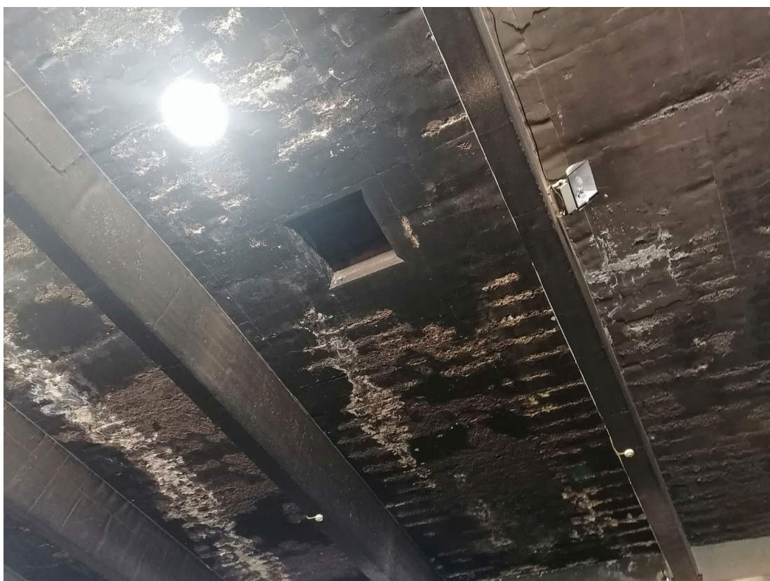
Εικόνα 13 Κοντινότερη άποψη κάτω παρειάς πλάκας οροφής, σε διάφορα τμήματα.
