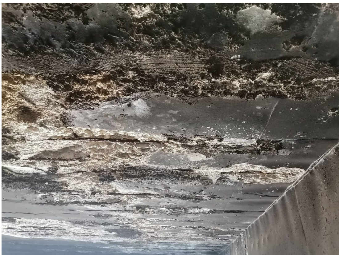
Εικόνα 12 Κοντινότερη άποψη κάτω παρειάς πλάκας οροφής, σε διάφορα τμήματα.
