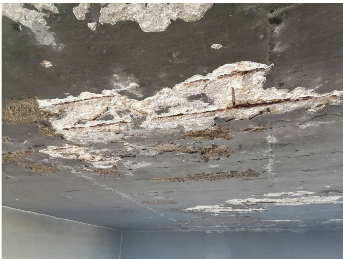
Εικόνα 10 Κοντινότερη άποψη κάτω παρειάς πλάκας οροφής, σε διάφορα τμήματα.
