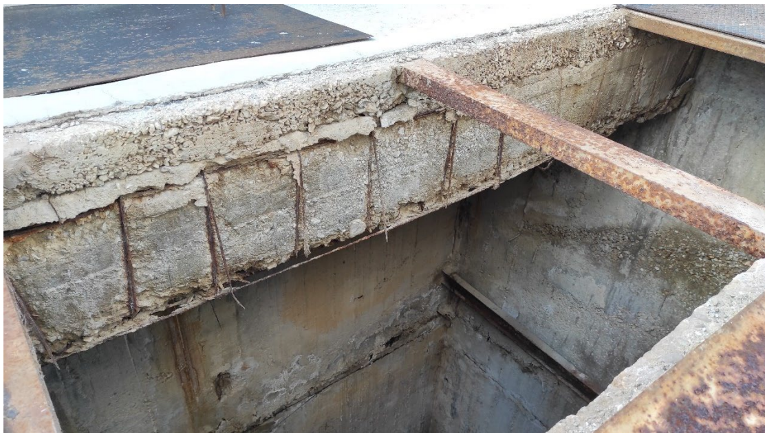
Φωτογραφία 14 Αποψη φρεατίου άντλησης νερού ψύξεως - διάβρωση οπλισμού δοκών.
