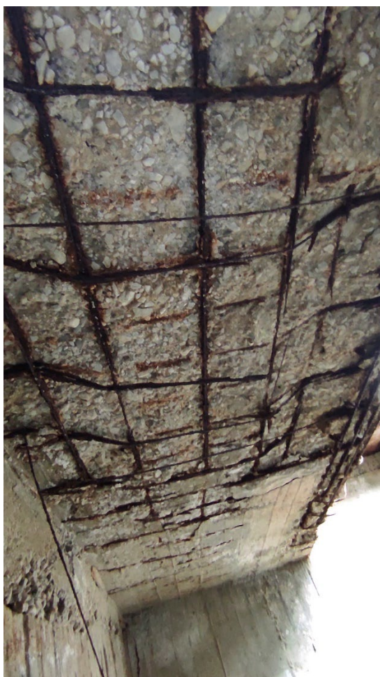
Φωτογραφία 19 Αποψη φρεατίου άντλησης νερού ψύξεως – πλήρης διάβρωση οπλισμού πλάκας οροφής και πλήρης αστοχία επικάλυψης σκυροδέματος.
