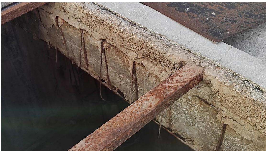
Φωτογραφία 15 Αποψη φρεατίου άντλησης νερού ψύξεως - διάβρωση οπλισμού δοκών.
