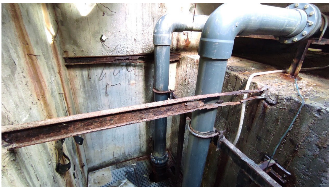
Φωτογραφία 22 Αστοχία βοηθητικών μεταλλικών διατομών.
