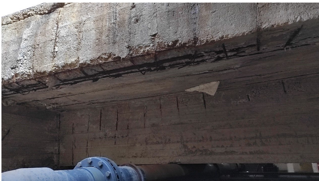
Φωτογραφία 17 Αποψη φρεατίου άντλησης νερού ψύξεως – διάβρωση οπλισμού δοκών.
