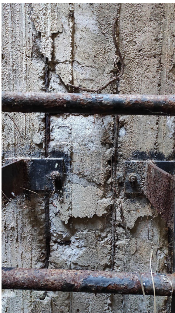
Φωτογραφία 25 Διάβρωση οπλισμού τοιχίων και αστοχία επικάλυψης σκυροδέματος.
