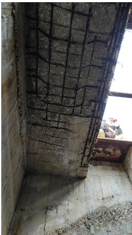
Φωτογραφία 20 Άποψη φρεατίου άντλησης νερού ψύξεως – πλήρης διάβρωση οπλισμού πλάκας οροφής και πλήρης αστοχία επικάλυψης σκυροδέματος
