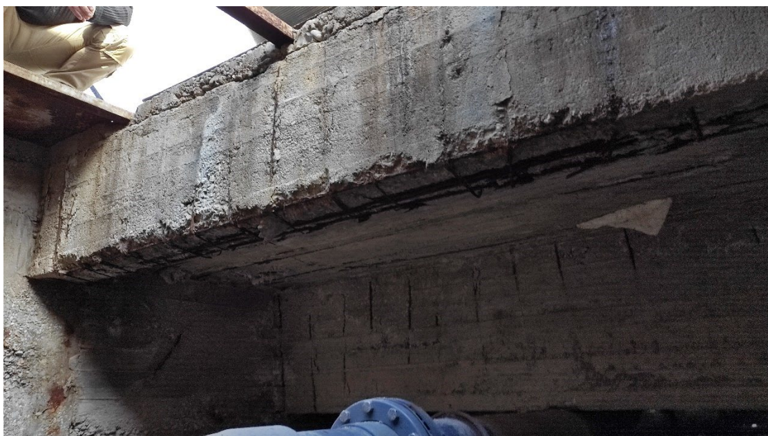
Φωτογραφία 16 Αποψη φρεατίου άντλησης νερού ψύξεως – διάβρωση οπλισμού δοκών.
