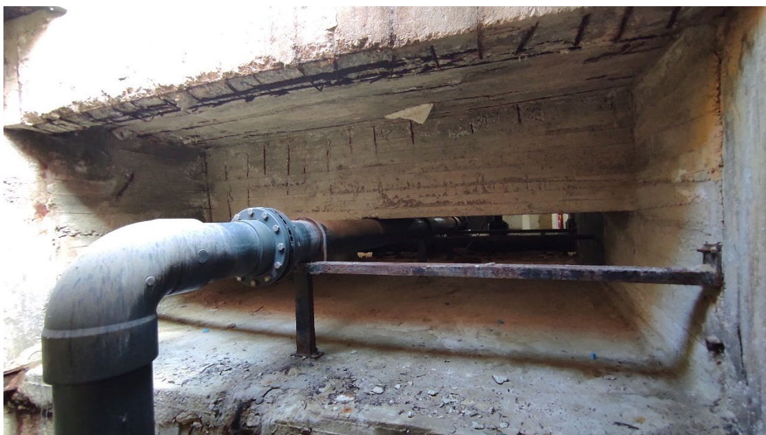
Φωτογραφία 18 Αποψη φρεατίου άντλησης νερού ψύξεως – διάβρωση οπλισμού δοκών.
