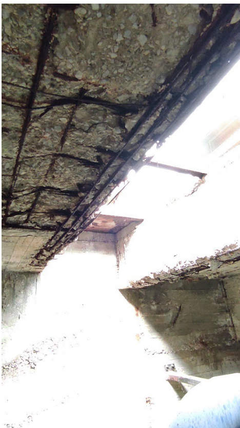
Φωτογραφία 21 Άποψη φρεατίου άντλησης νερού ψύξεως – πλήρης διάβρωση οπλισμού πλάκας οροφής και πλήρης αστοχία επικάλυψης σκυροδέματος
