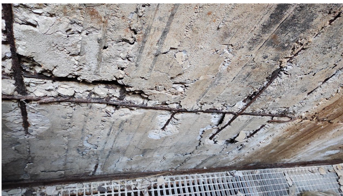
Φωτογραφία 23 Διάβρωση οπλισμού τοιχίων και αστοχία επικάλυψης σκυροδέματος.
