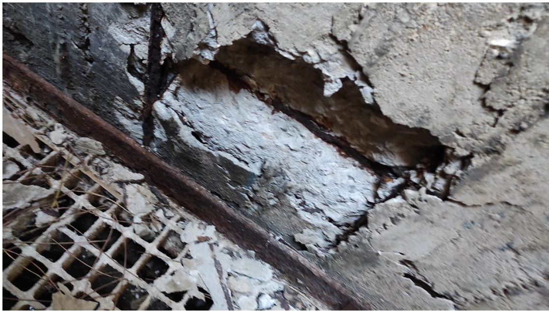
Φωτογραφία 26 Διάβρωση οπλισμού τοιχίων και αστοχία επικάλυψης σκυροδέματος.
