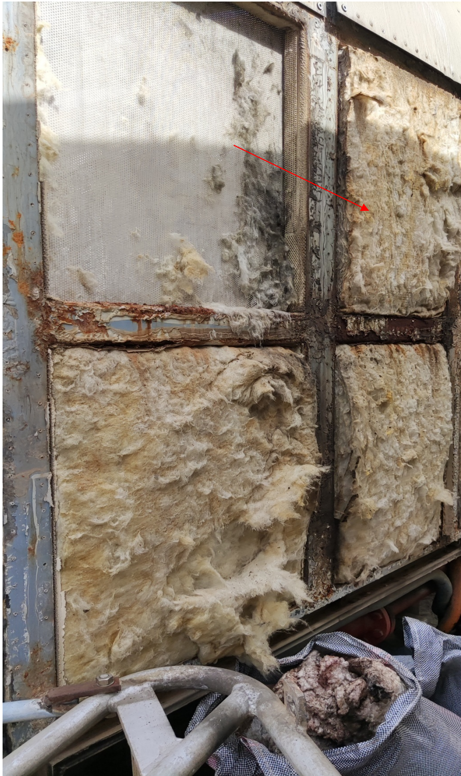
Εικόνα 8: Μόνωση κελύφους διέγερσης
