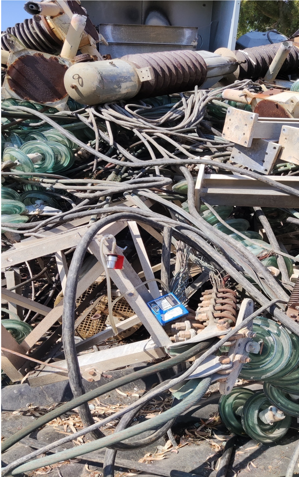
Εικόνα 16: Μέτρηση αέρος στον αποσυναρμολογημένο Υποσταθμό
