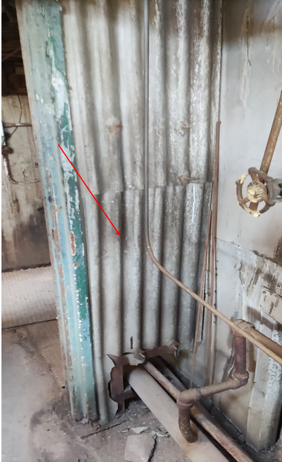
Εικόνα 1: Χώρος Λέβητα Ατμού 2 – Κυματοειδές φύλλο
