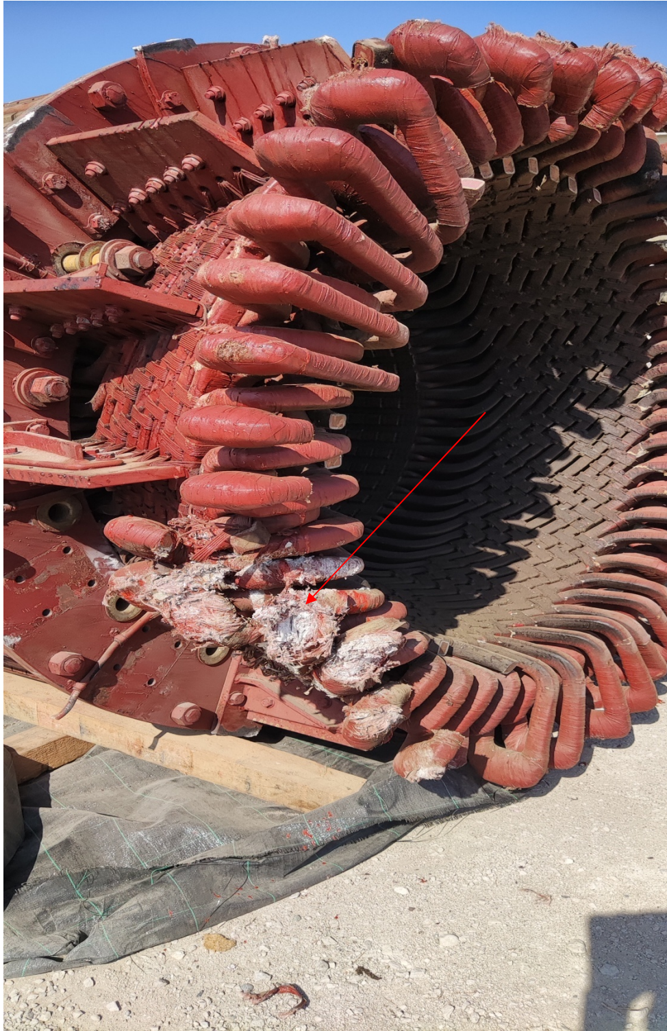
Εικόνα 4: Μόνωση στάτη γεννήτριας
