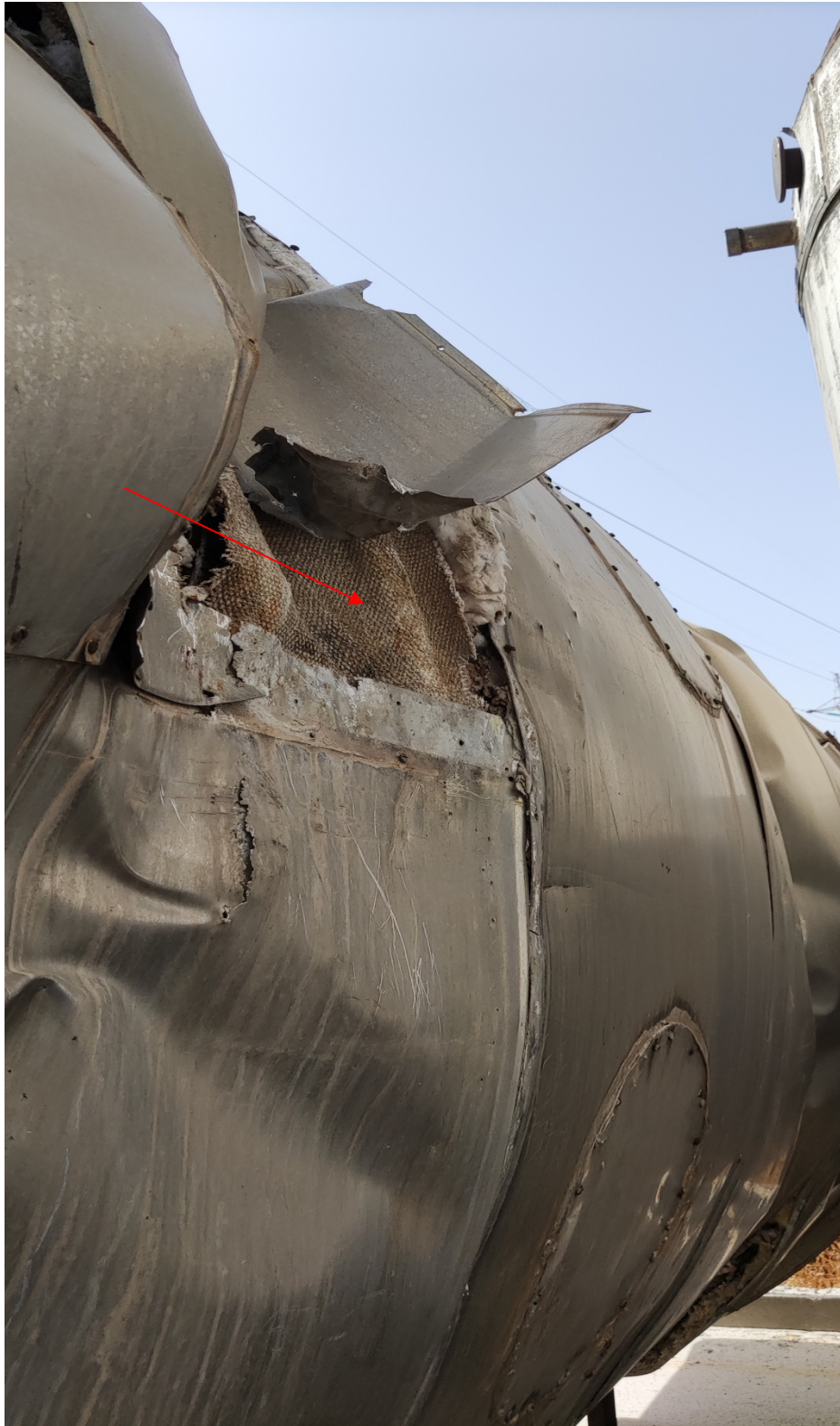
Εικόνα 3: Μόνωση περιβλήματος θαλάμου καύσεως
