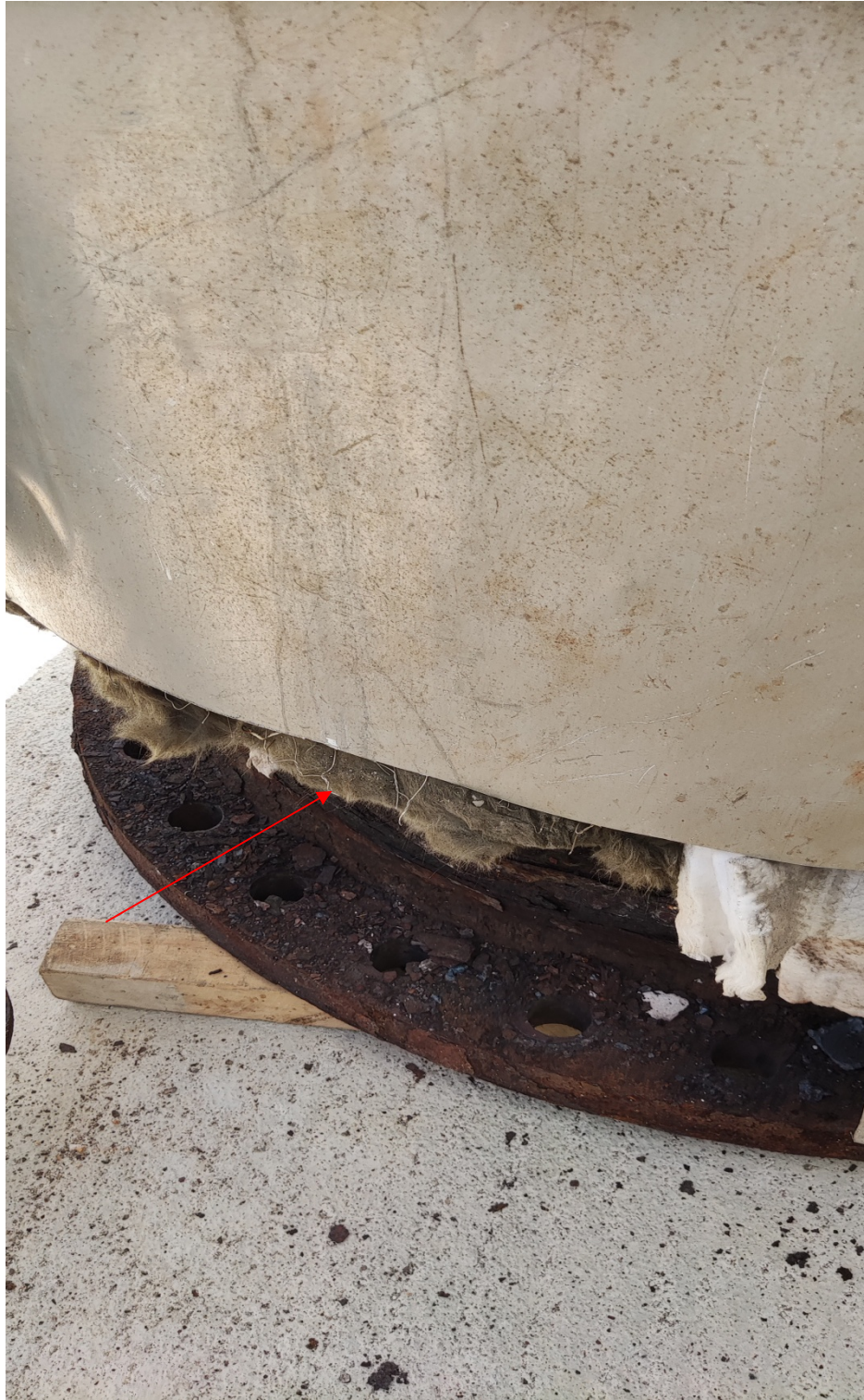
Εικόνα 9: Μόνωση θαλάμου καύσης προς εισαγωγή στο στρόβιλο
