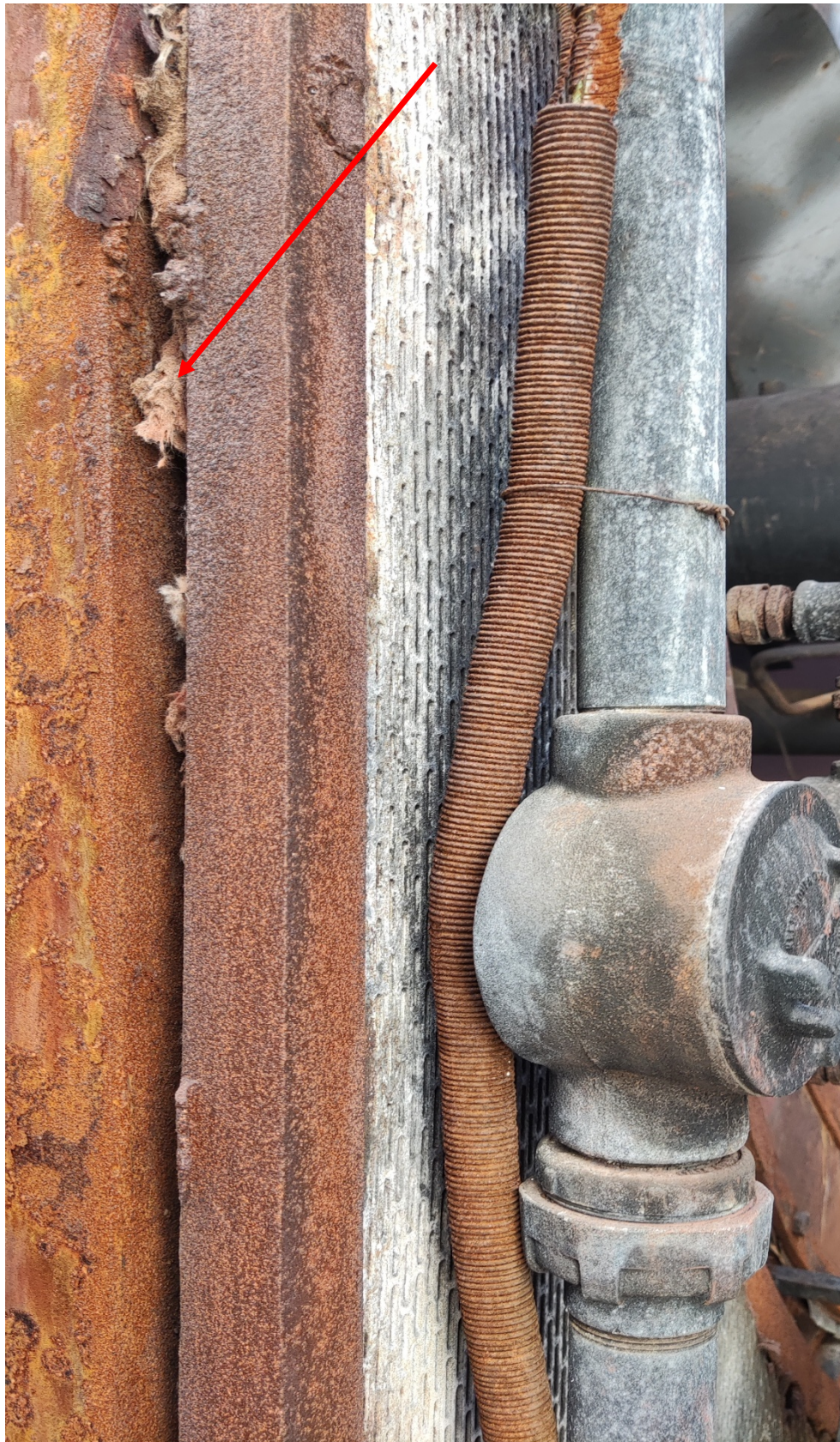
Εικόνα 7: Μόνωση SMF στην έξοδο στροβίλου
