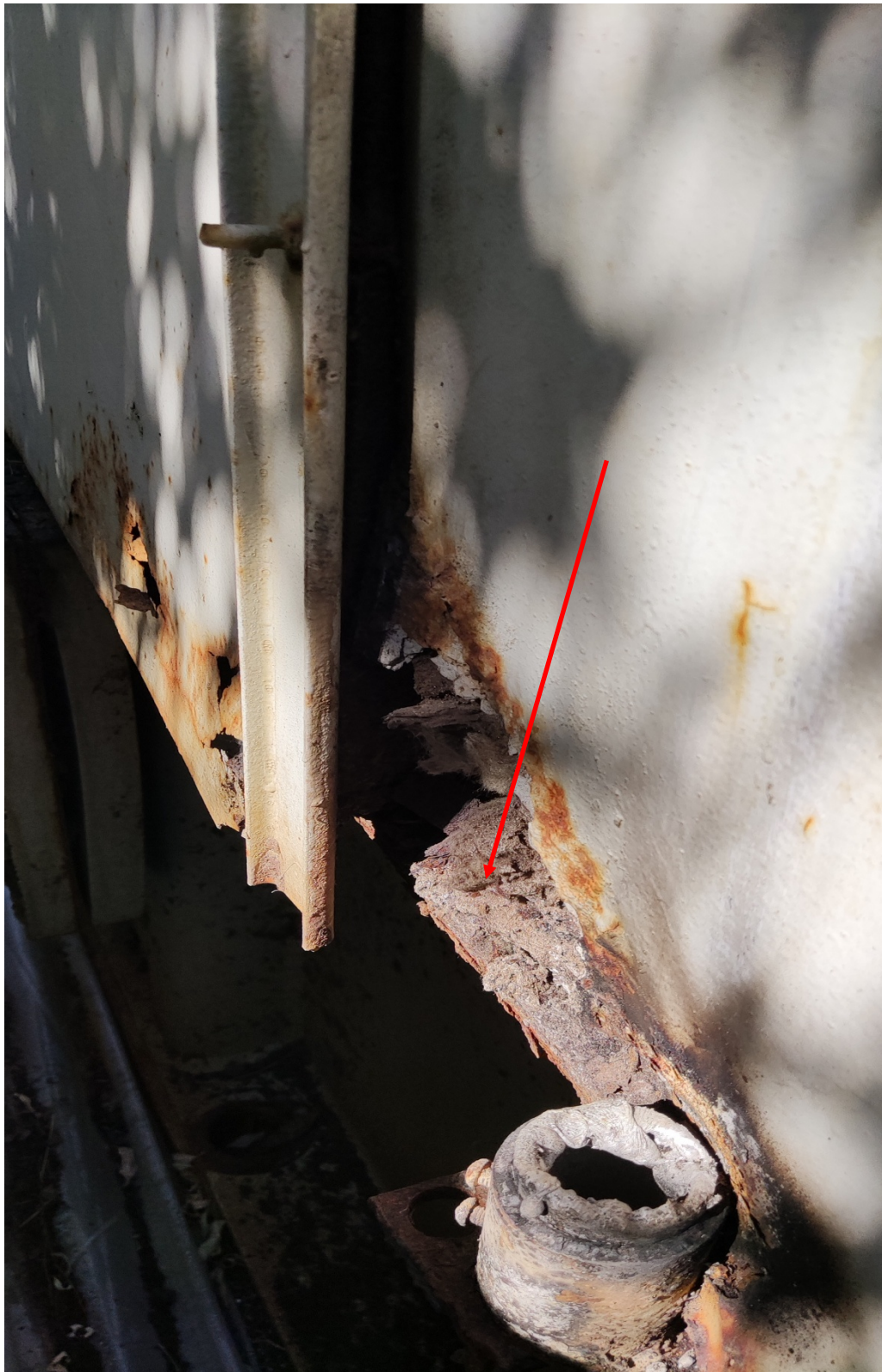
Εικόνα 9: Μόνωση SMF τοιχώματος αεροστροβίλου
