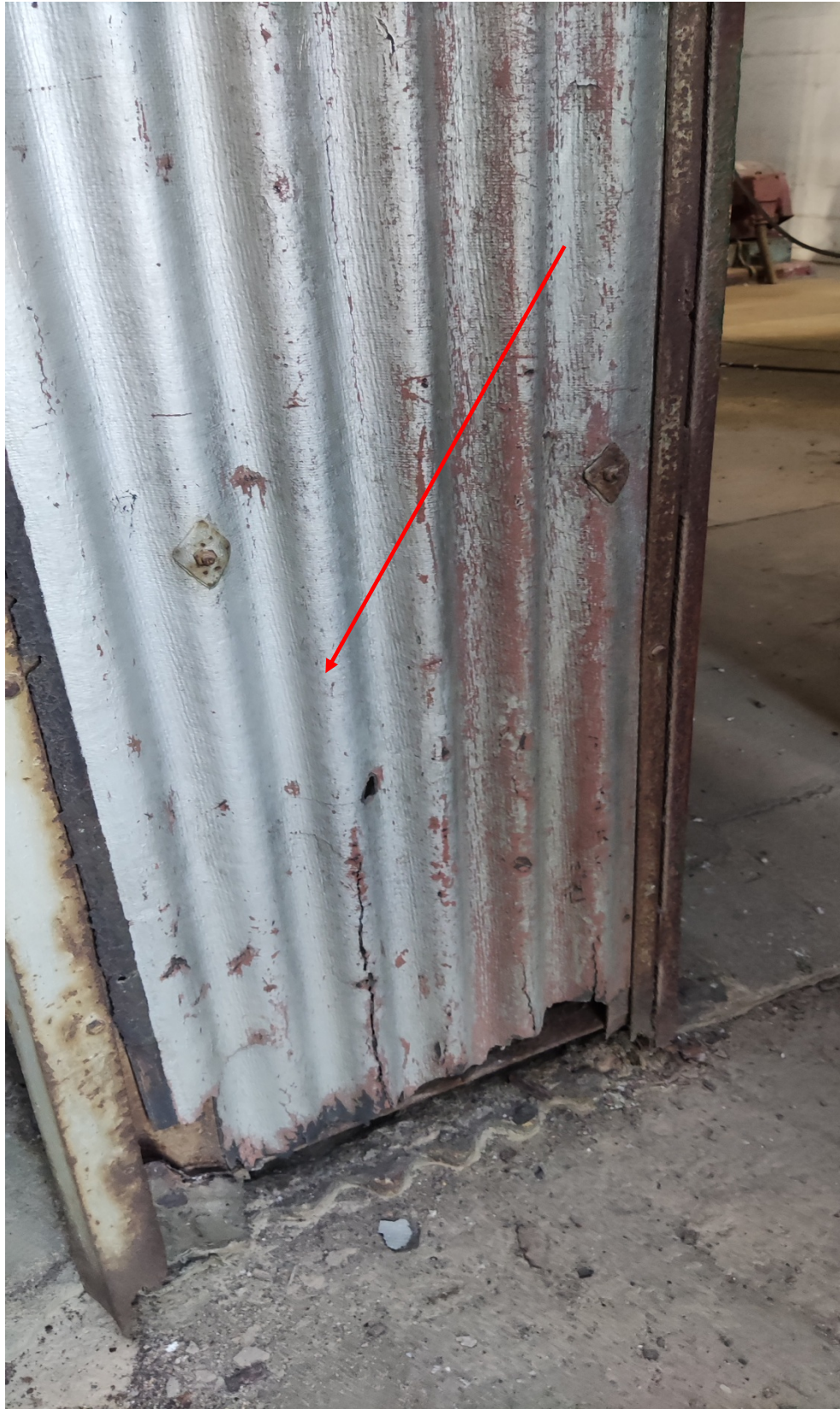
Εικόνα 2: Χώρος Λέβητα Ατμού 1 – Κυματοειδές φύλλο
