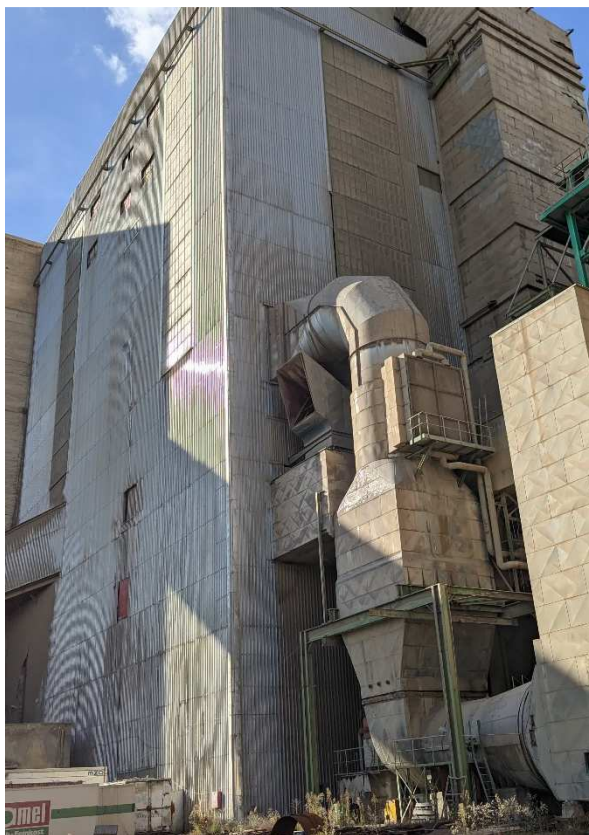
Εικόνα 5-18: Εξωτερική άποψη του Λεβητοστασίου της μονάδας I
