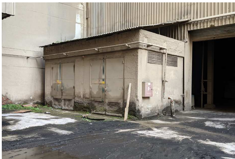
Εικόνα 5-87: Κτήρια στέγασης Μετασχηματιστών Υ4.2-01Α έως D και Υ4.2-02Α έως D
