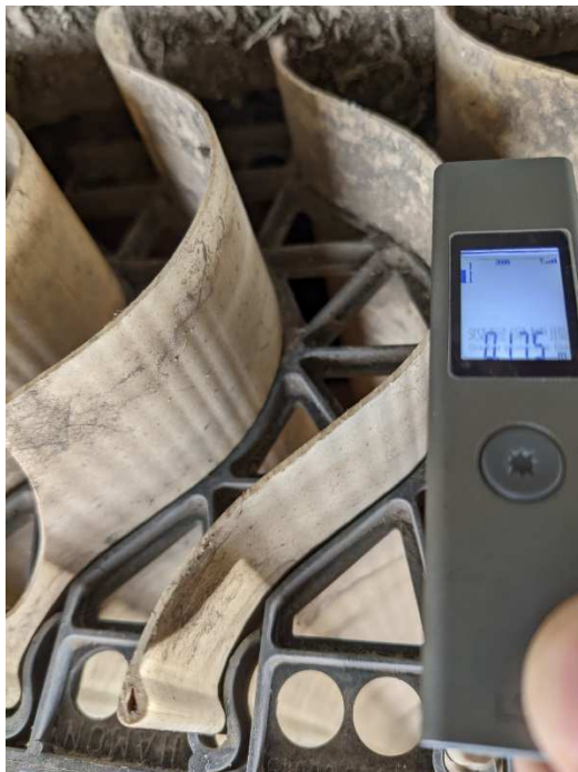
Εικόνα 5-30: Εσωτερικό Πύργου Ψύξεως
