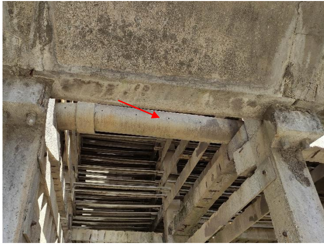
Εικόνα 7: A06 – Περιμετρικός Σωλήνας / Πύργος Ψύξης Μονάδας I
