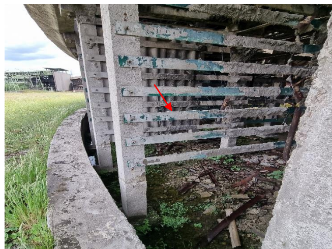
Εικόνα 14: A13 – Οριζόντια Στηρίγματα / Πύργος Ψύξης Μονάδας II
