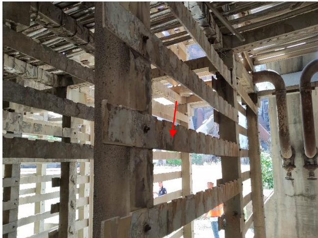
Εικόνα 3: A02 – Οριζόντια Στηρίγματα / Πύργος Ψύξης Μονάδας I
