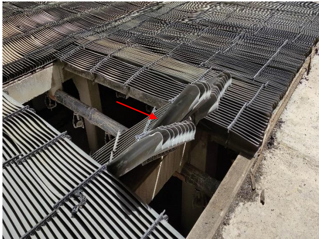
Εικόνα 9: A08 – Πτερύγια Άνω Στρώμα Πακέτου / Πύργος Ψύξης Μονάδας III
