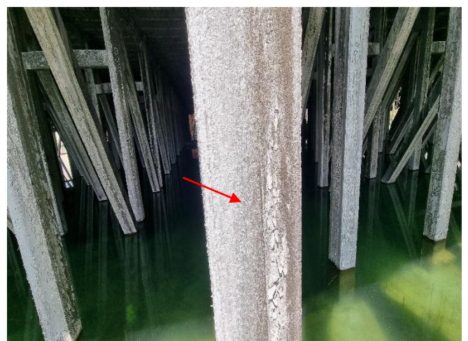
Εικόνα 12: A11 – Κολώνες Στήριξης / Πύργος Ψύξης Μονάδας III
