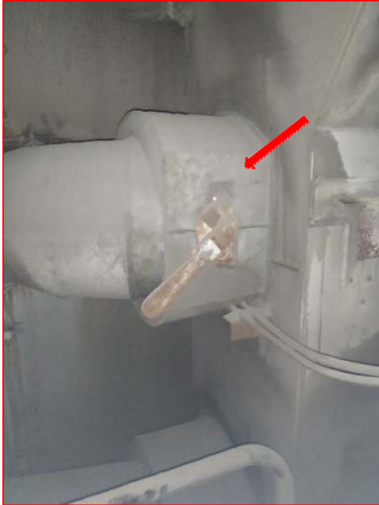
Εικόνα 4: (Λεβητοστάσιο – κτίριο 2c – επίπεδο +8,50μ – Πόρτα Ν° 39.) – Κυκλικά διαφράγματα ρύθμισης παροχής αέρα (damper) διαμέτρου Φ40. Ο εξοπλισμός περιέχει στεγανωτικό κορδόνι στις δύο πλευρές της μεταλλικής σύνδεσης που αναμένεται να είναι αμιαντούχο. Ο συγκεκριμένος εξοπλισμός εντοπίστηκε σε κάθε επίπεδο από το +5,50μ μέχρι το +22,00μ.
