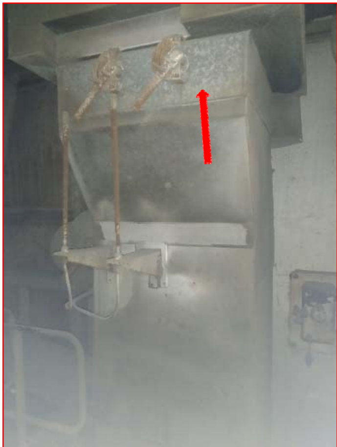
Εικόνα 6: (Λεβητοστάσιο – κτίριο 2c – επίπεδο +8,50μ – Πόρτα Ν° 39.) – Τετράγωνα διαφράγματα ρύθμισης παροχής αέρα (damper) με διαστάσεις 60x80. Στους στυπιοθαλάμους του εξοπλισμού αναμένεται ότι υπάρχει κάποιο στεγανωτικό κορδόνι, το οποίο είναι πιθανό ότι είναι αμιαντούχο.
