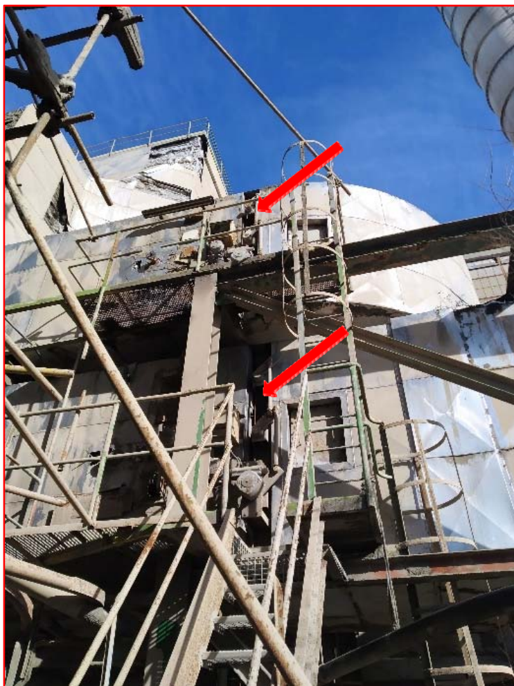
Εικόνα 12: (Σύστημα αποκομιδής τέφρας / Σιλό τέφρας – κτίριο 3c – επίπεδο +2,00μ) – Τετράγωνα διαφράγματα ρύθμισης παροχής αέρα (damper). Στους στυπιοθαλάμους του εξοπλισμού αναμένεται ότι υπάρχει κάποιο στεγανωτικό κορδόνι, το οποίο είναι πιθανό ότι είναι αμιαντούχο.
