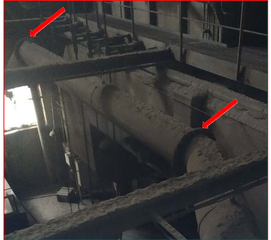
Εικόνα 9: (Λεβητοστάσιο – κτίριο 2c – επίπεδο +12,50μ – Πόρτα Ν° 40) Κυκλικές συνδέσεις αγωγών με κοχλίες. Στο χώρο του λεβητοστασίου παρατηρήθηκαν πολλές παρόμοιες συνδέσεις μεταξύ αγωγών. Το στεγανωτικό υλικό (φλάντζα) μεταξύ των συνδέσεων ενδέχεται να είναι αμιαντούχο.
