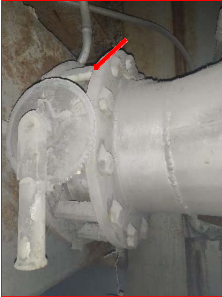
Εικόνα 1: (Λεβητοστάσιο – κτίριο 2c – επίπεδο +8,50μ – Πόρτα Ν° 39.) – Κυκλικά διαφράγματα ρύθμισης παροχής αέρα (damper) διαμέτρου Φ40. Ο εξοπλισμός περιέχει στεγανωτικό κορδόνι στις δύο πλευρές της μεταλλικής σύνδεσης που αναμένεται να είναι αμιαντούχο. Ο συγκεκριμένος εξοπλισμός εντοπίστηκε σε πολλά σημεία κατά μήκος της γραμμής αέρος στο σύστημα καύσης.
