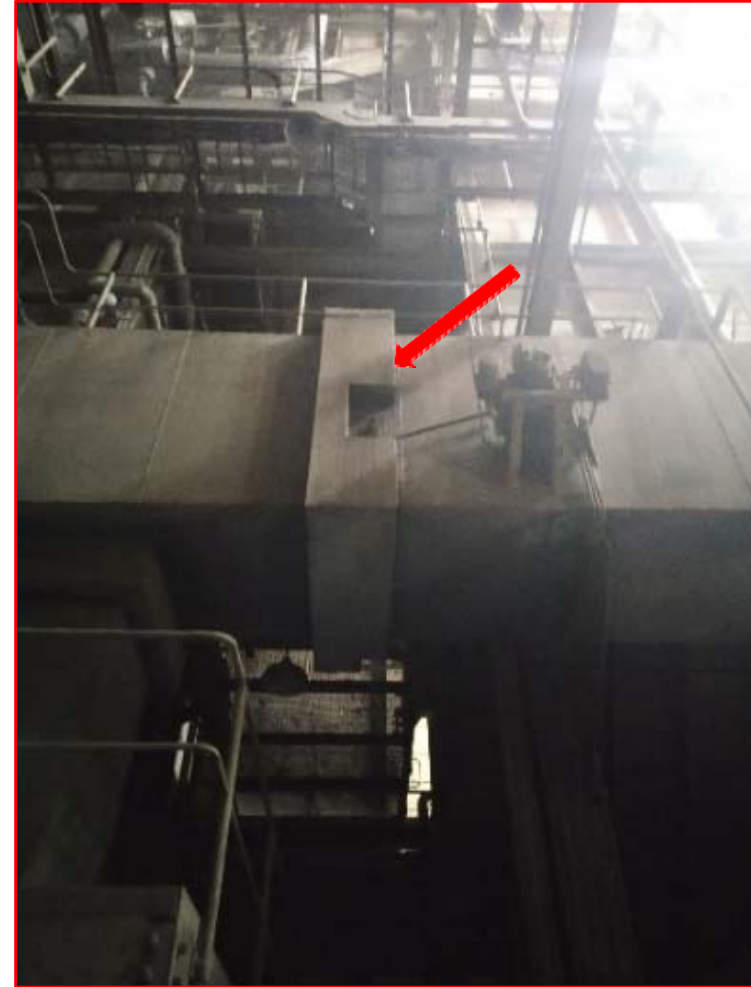
Εικόνα 5: (Λεβητοστάσιο – κτίριο 2c – επίπεδο +8,50μ – Πόρτα Ν° 39.) – Τετράγωνα διαφράγματα ρύθμισης παροχής αέρα (damper) με διαστάσεις 160x160. Στους στυπιοθαλάμους του εξοπλισμού αναμένεται ότι υπάρχει κάποιο στεγανωτικό κορδόνι, το οποίο είναι πιθανό ότι είναι αμιαντούχο.
