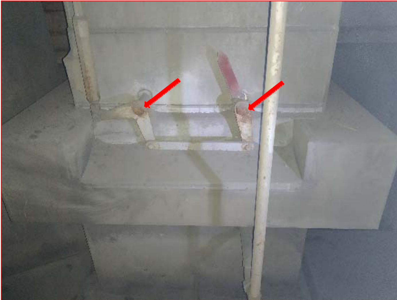
Εικόνα 3: (Λεβητοστάσιο – κτίριο 2c – επίπεδο +8,50μ – Πόρτα Ν° 39.) – Τετράγωνα διαφράγματα ρύθμισης παροχής αέρα (damper) με διαστάσεις 120x90. Στους συτιποθαλάμους του εξοπλισμού αναμένεται ότι υπάρχει κάποιο στεγανωτικό κορδόνι, το οποίο είναι πιθανό ότι είναι αμιαντούχο.
