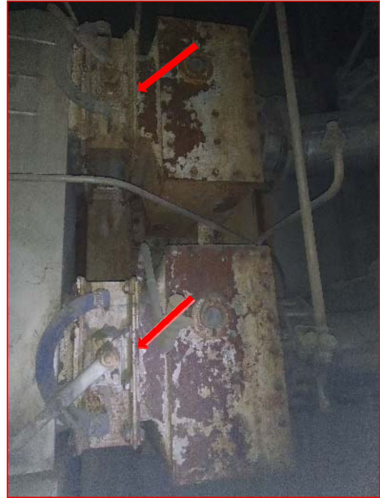
Εικόνα 2: (Λεβητοστάσιο – κτίριο 2c – επίπεδο +8,50μ – Πόρτα Ν° 39.) - Τετράγωνα διαφράγματα ρύθμισης παροχής αέρα (damper) με διαστάσεις 40x50. Στους στυπιοθαλάμους του εξοπλισμού αναμένεται ότι υπάρχει στεγανωτικό κορδόνι, το οποίο είναι πιθανό ότι είναι αμιαντούχο.
