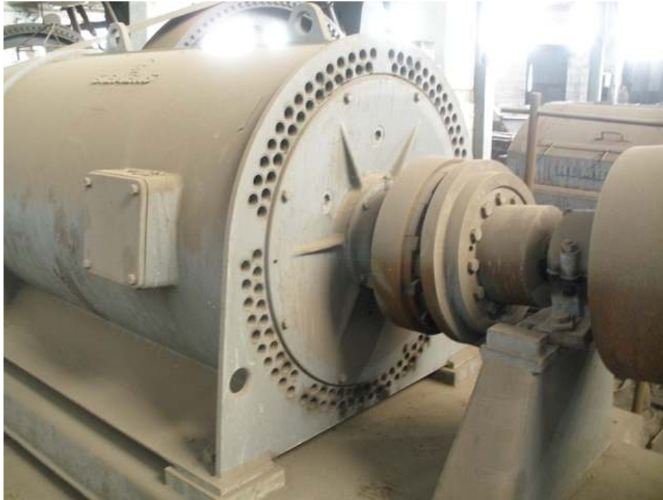
Φωτ. 121. Ηλεκτροκινητήρας και σύνδεσμος πιεστηρίου.
