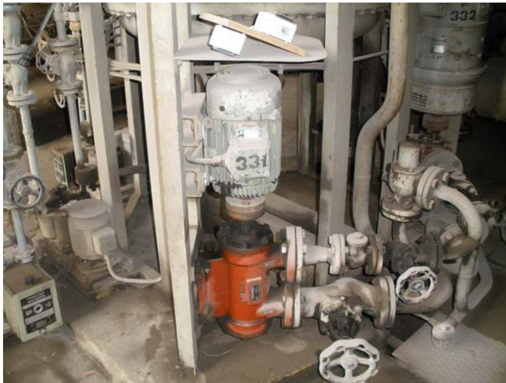
Φωτ. 50. Μηχανή παραγωγής Υδρογόνου, κάτω τμήμα. Έδραση στο δάπεδο.
