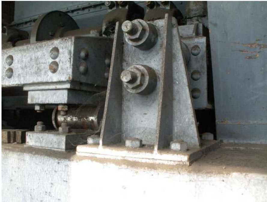
Φωτ. 71. Κόσκινο φυσικού λιγνίτη. Λεπτομέρεια κυλιόμενου τριβέα (roller) πάνω στον οποίο ταλαντώνεται η πλάκα δονήσεων.
