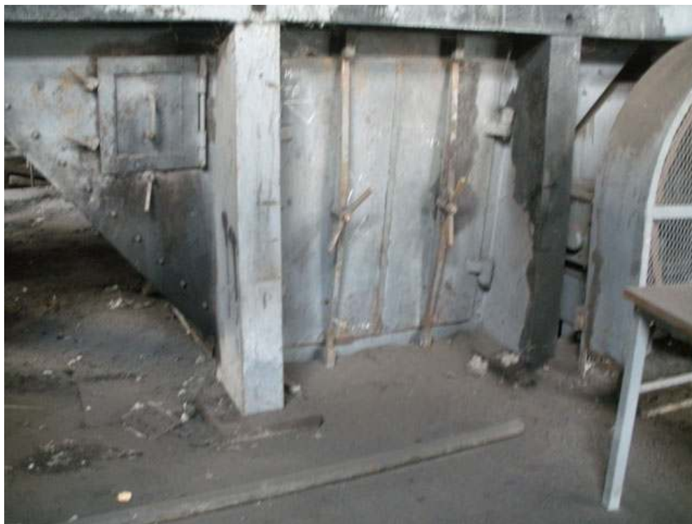
Φωτ. 106. Σπαστήρας φυσικού λιγνίτη. Πέλματα του σπαστήρα πρώτου σταδίου, με τους κοχλίες δαπέδου.
