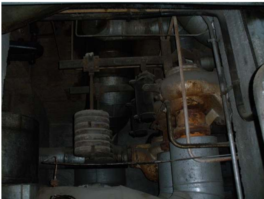
Φωτ. 41. Δίκτυα ατμού στο υπόγειο τμήμα του στροβίλου.
