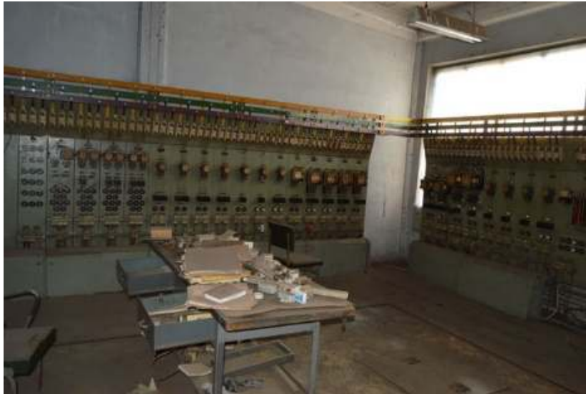
Φωτ. 125. Πίνακας παροχής ισχύος στο κτίριο.
