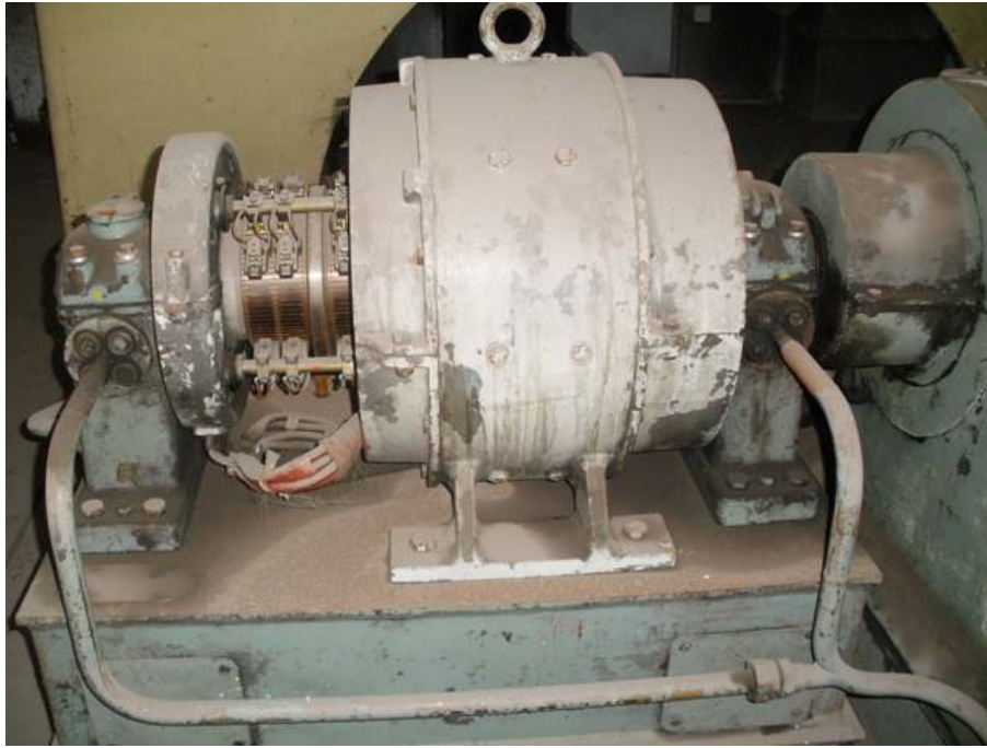
Φωτ. 29. Διεγέρτρια γεννήτριας. Τα δίκτυα προς τους τριβείς αφορούν στην λίπανση. Η αποσυναρμολόγηση και καθαίρεση της διεγέρτριας ακολουθεί τα εξής στάδια: 1. Ηλεκτρικά δίκτυα. 2. Δίκτυα λίπανσης. 3. Σύνδεσμος (coupler) του άξονα. 4. Καβαλέτα τριβέων άξονα. 5. Κοχλίες βάσεως αριστερού τριβέως. 6. Αξονική εξάρμωση τυμπάνου. 7. Καθαίρεση στάτη και δεξιού τριβέως. 8. Καθαίρεση βάσεως του συνόλου.
