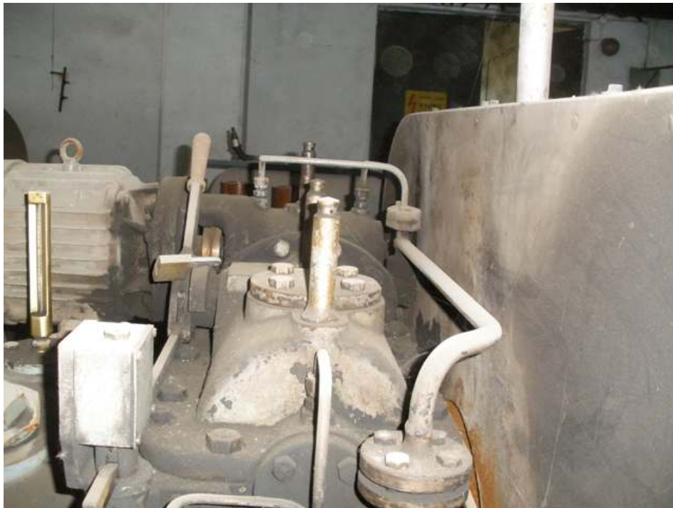
Φωτ. 17. Θερμόμετρο τριβέα και δίκτυα λίπανσης.
