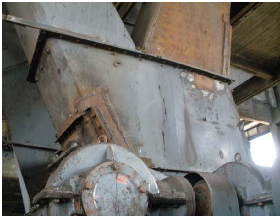
Φωτ. 101. Σπαστήρας φυσικού λιγνίτη. Χοάνες τροφοδοσίας λιγνίτη.
