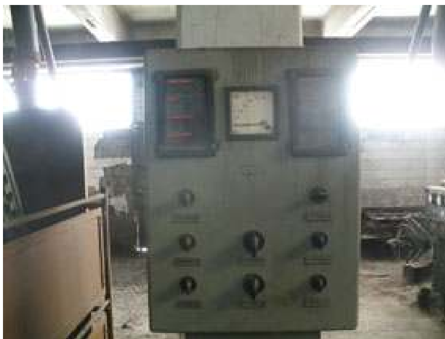
Φωτ. 124. Πίνακας χειρισμού ηλεκτροκινητήρα. Τοποθέτηση σε κιβώτιο με την ένδειξη «Α/Α 7 πίνακας».
