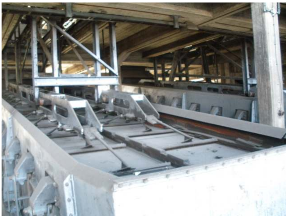
Φωτ. 66. Κόσκινο φυσικού λιγνίτη. Μεσαίο τμήμα ξέστρα.
