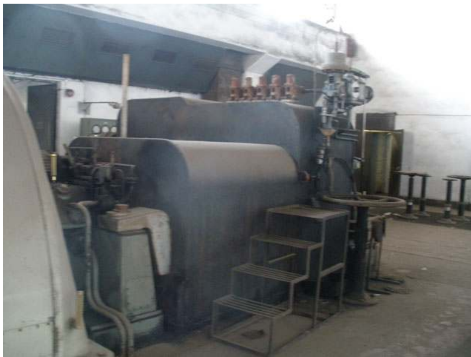
Φωτ. 15 Στροβιλογεννήτρια. Η πλευρά της γεννήτριας.
