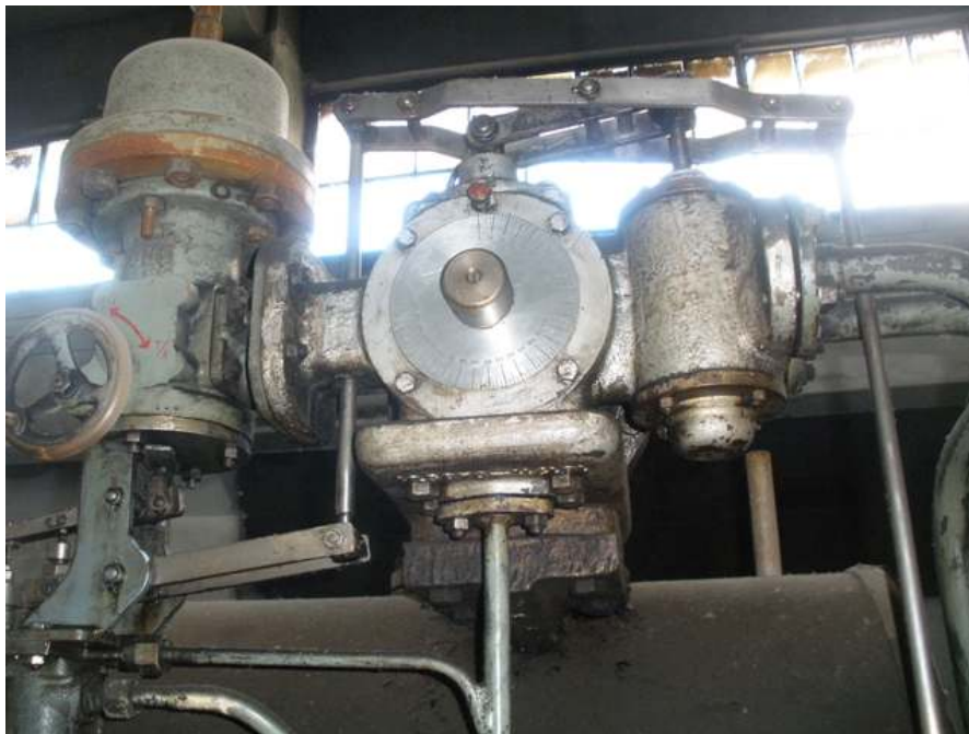
Φωτ. 24 Ρυθμιστής ισχύος. Στο κέντρο ο γωνιακός κινητήρας και λεπτομέρεια της στήριξής του και των δικτύων. Αριστερά ο κώδωνας αντιπίεσης και δεξιά σε επαφή με τον κινητήρα η βαλβίδα ατμού. Η βαλβίδα ατμού θα αποσυναρμολογηθεί μαζί με τον γωνιακό κινητήρα.
