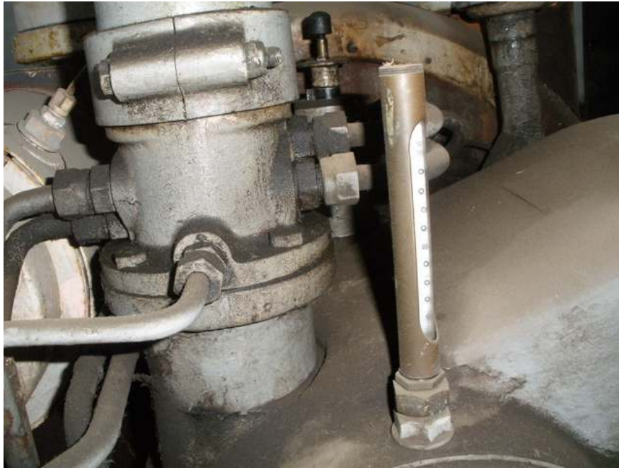
Φωτ. 7. Τμήμα του ρυθμιστή ισχύος.
