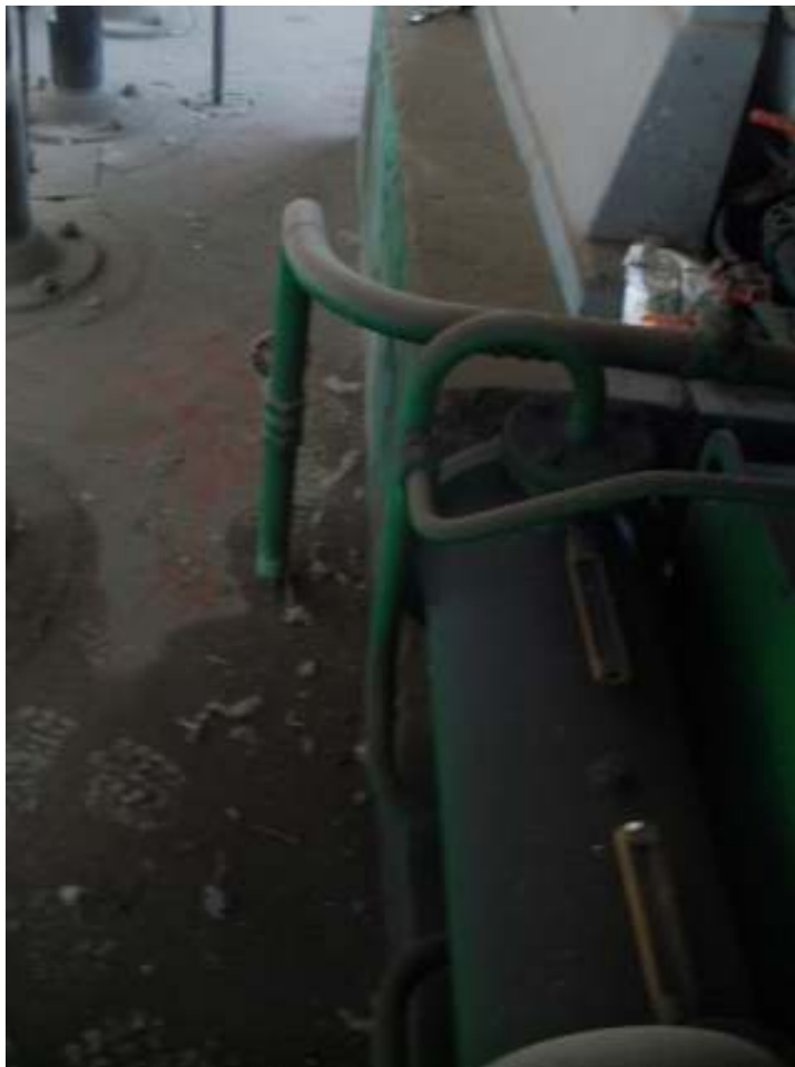
Φωτ. 10 . Δίκτυα και ψυγείο ελαίου.
