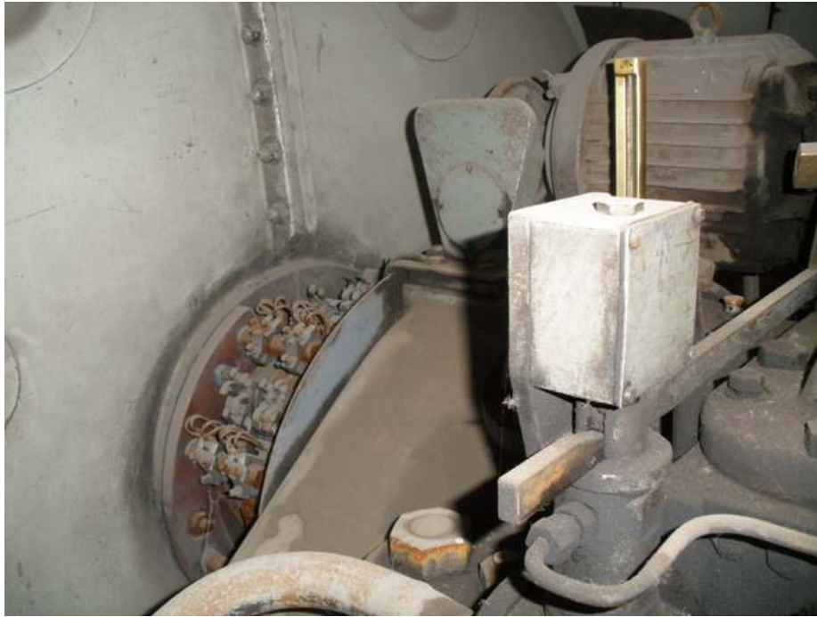
Φωτ. 18 Θερμόμετρο τριβέα μεταξύ στροβίλου και εναλλακτήρα. Τμήμα εμπλοκής του μηχανισμού κρίκου.
