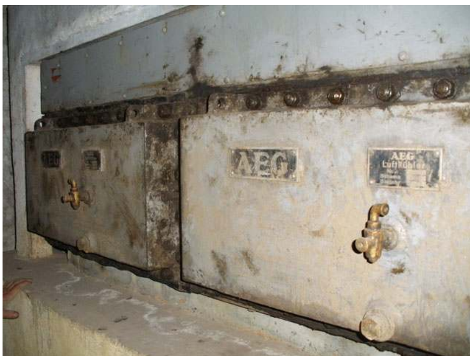
Φωτ. 42. Υπόγειο τμήμα γεννήτριας. Σύστημα ψύξης.
