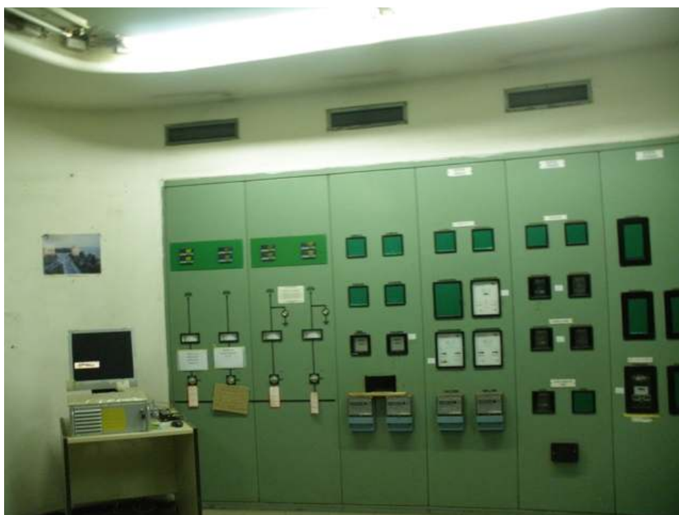
Φωτ. 47. Πίνακας ελέγχου παραγωγής ηλεκτρικής ενέργειας. Όψη ζεύξης της γεννήτριας.
