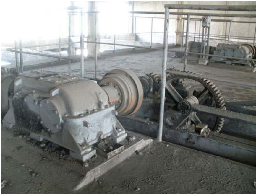
Φωτ. 61. Κόσκινο φυσικού λιγνίτη. Άνω τμήμα. Μηχανισμός κίνησης του ξέστρου. Γωνιακός μειωτήρας και σύνδεσμος (coupler).
