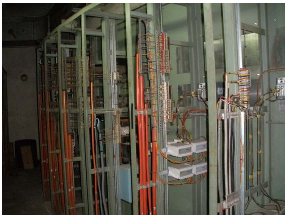
Φωτ. 49. Πίνακας ελέγχου παραγωγής ηλεκτρικής ενέργειας. Ερμάριο συνδέσεων στοιχείων ελέγχου.
