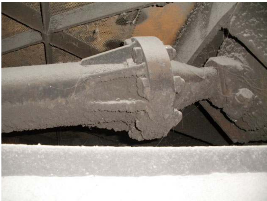
Φωτ. 77. Κόσκινο φυσικού λιγνίτη. Λεπτομέρεια σύνδεσης διωστήρα με το πλαίσιο κοσκινίσματος.
