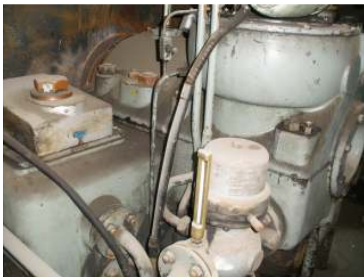
Φωτ. 20. Θερμόμετρο λιπαντικού φυγοκεντρικού στοιχείου ρυθμιστή ισχύος.
