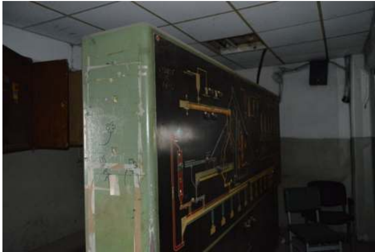
Φωτ. 126. Πίνακας ελέγχου μηχανημάτων.
