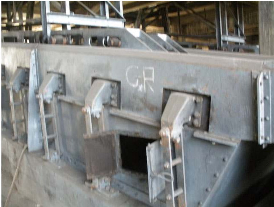
Φωτ. 91. Κόσκινο φυσικού λιγνίτη. Πλευρικά στελέχη συγκράτησης πλαισίου κοσκινίσματος. Θυρίδα πρόσβασης στο εσωτερικό του κόσκινου.
