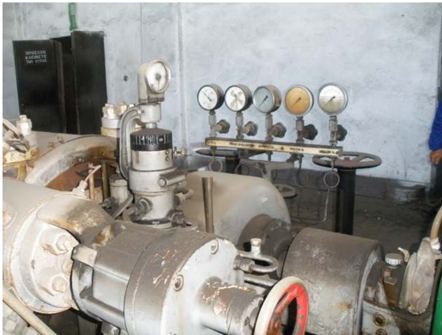
Φωτ. 8 .Όργανα και χειριστήρια του στροβίλου της τροφοδοτικής αντλίας των λεβήτων.
