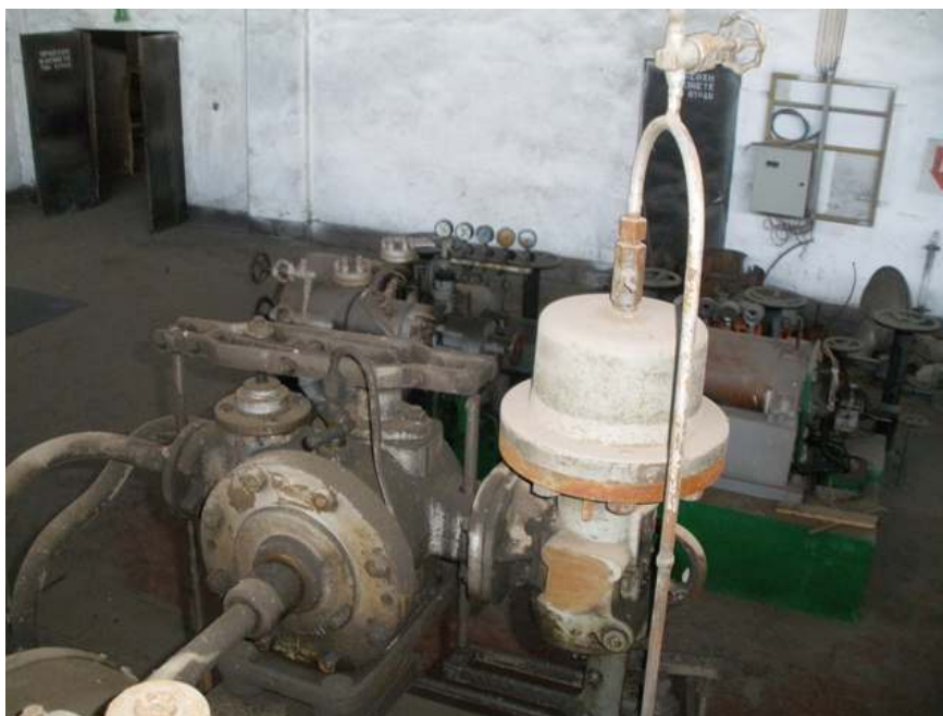
Φωτ. 26. Ρυθμιστής ισχύος. Πίσω όψη γωνιακού κινητήρα. Διακρίνεται το αρχικό τμήμα του άξονα προς τις ρυθμιστικές βαλβίδες του ατμοστροβίλου.
