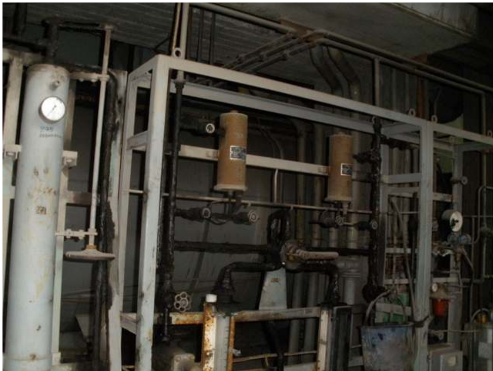
Φωτ. 52. Μηχανή παραγωγής Υδρογόνου, τμήμα φιαλών.
