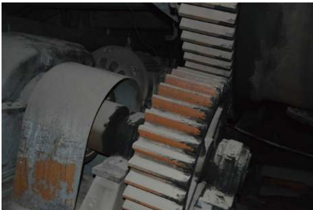
Φωτ. 116. Μειωτήρας κίνησης.
