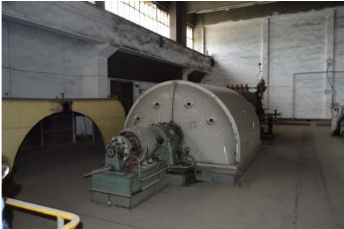
Γενική άποψη του χώρου στο κέντρο η γεννήτρια.
