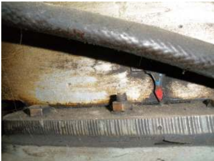
Φωτ. 40. Πέδιλο στροβίλου. Λεπτομέρεια δείκτη ρύθμισης διακένων κατά τον εγκάρσιο άξονα.
