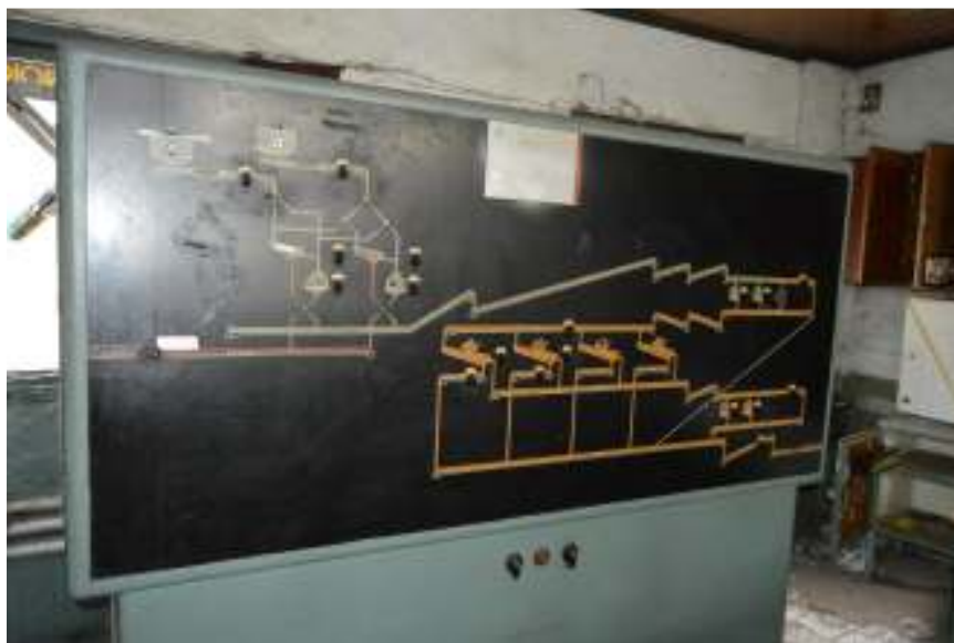
Φωτ. 110. Πίνακας ελέγχου.
