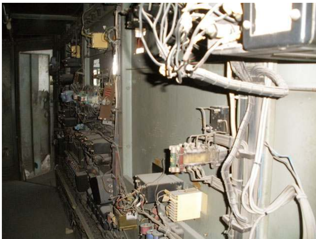
Φωτ. 46. Πίνακας ελέγχου ατμού, εσωτερικό. Διακρίνεται ο τρόπος έδρασής του στο δάπεδο.
