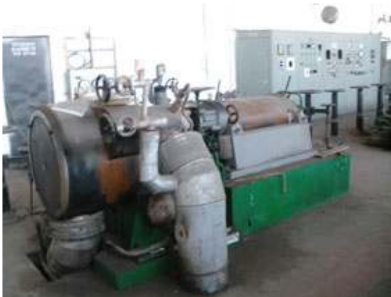
Φωτ. 1. Τροφοδοτική αντλία λέβητα. Σύνολο
