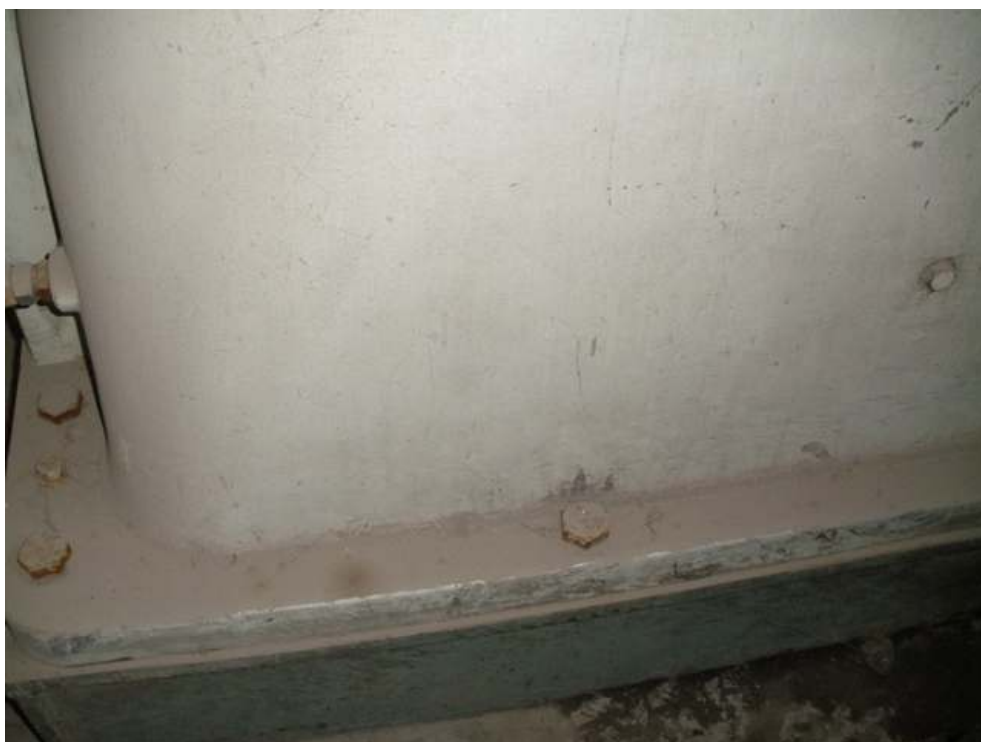
Φωτ. 33. Βίδες αποσυναρμολόγησης του καλύμματος της γεννήτριας.
