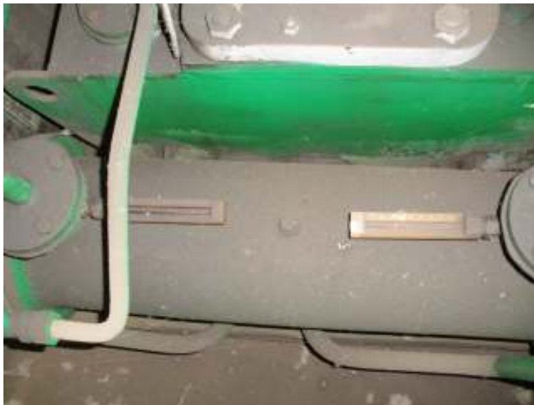
Φωτ. 6. Δεξαμενή, ψυγείο και όργανα θερμοκρασίας λαδιού.
