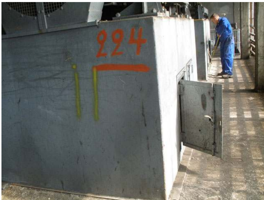
Φωτ. 74. Κόσκινο φυσικού λιγνίτη. Βάση δονούμενης πλάκας, άξονα και ηλεκτροκινητήρα.
