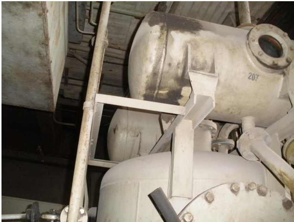
Φωτ. 51. Μηχανή παραγωγής Υδρογόνου, επάνω τμήμα.
