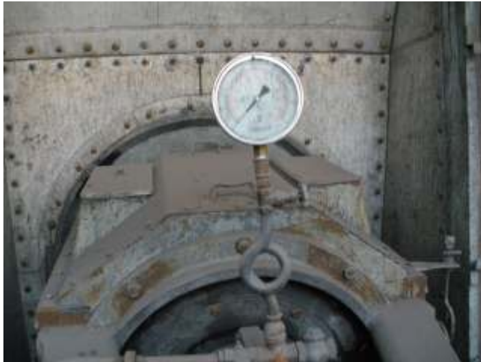
Φωτ. 113. Οπίσθιο έδρανο τυμπάνου. Όργανο πίεσης ατμού εξόδου.
