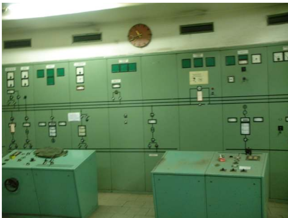
Φωτ. 48. Πίνακας ελέγχου παραγωγής ηλεκτρικής ενέργειας. Κονσόλες χειρισμού και ζεύξης των γεννητριών.
