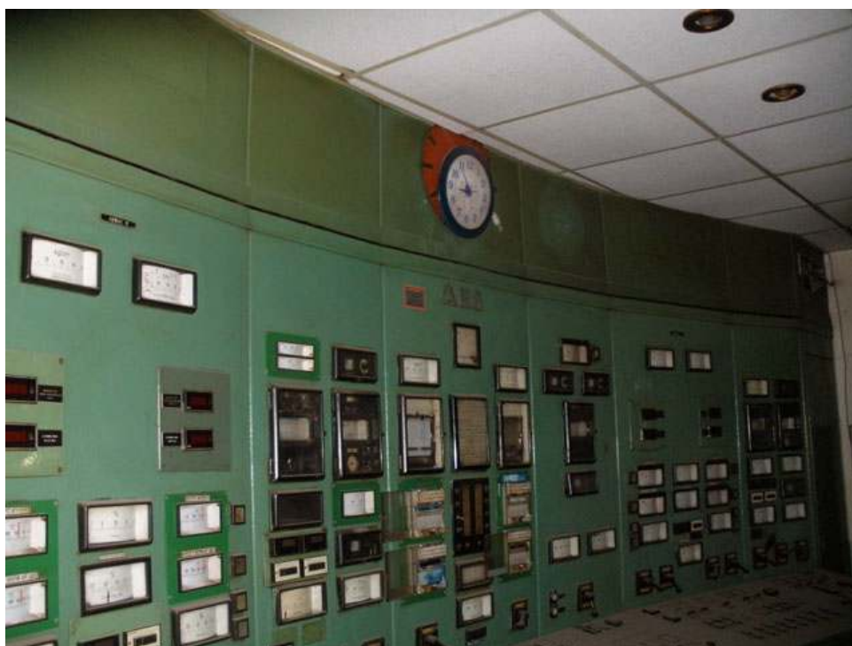
Φωτ. 45. Πίνακας ελέγχου ατμού, όψη λέβητα.
