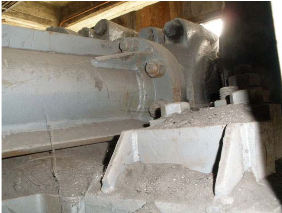
Φωτ. 75. Κόσκινο φυσικού λιγνίτη. Σύνδεση διωστήρων με την δονούμενη πλάκα. (1 ο τμήμα διωστήρων)
