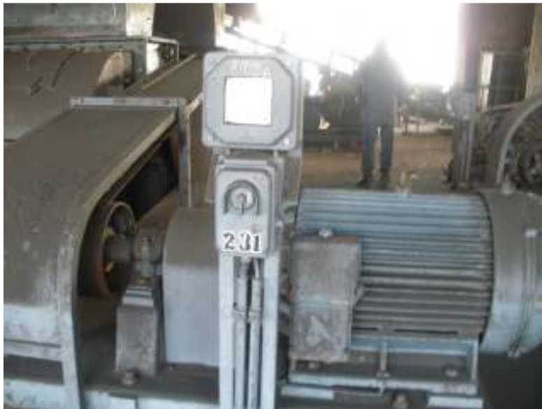
Φωτ. 97. Περιστροφικό κόσκινο. Κινητήρας, βάση, προφυλακτήρας ιμάντα, στυλίδιο διακόπτη. (ο αριθμός αντιστοιχεί σε παρακείμενο μηχάνημα ευκολότερο στην φωτογράφιση)
