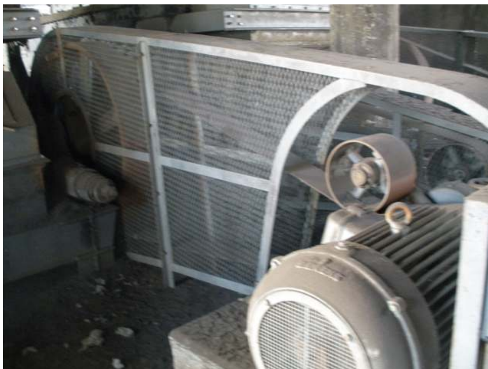
Φωτ. 104. Σπαστήρας φυσικού λιγνίτη. Ηλεκτροκινητήρας δεύτερου σταδίου. Εντελώς συμμετρικά υπάρχει και δεύτερος κινητήρας.
