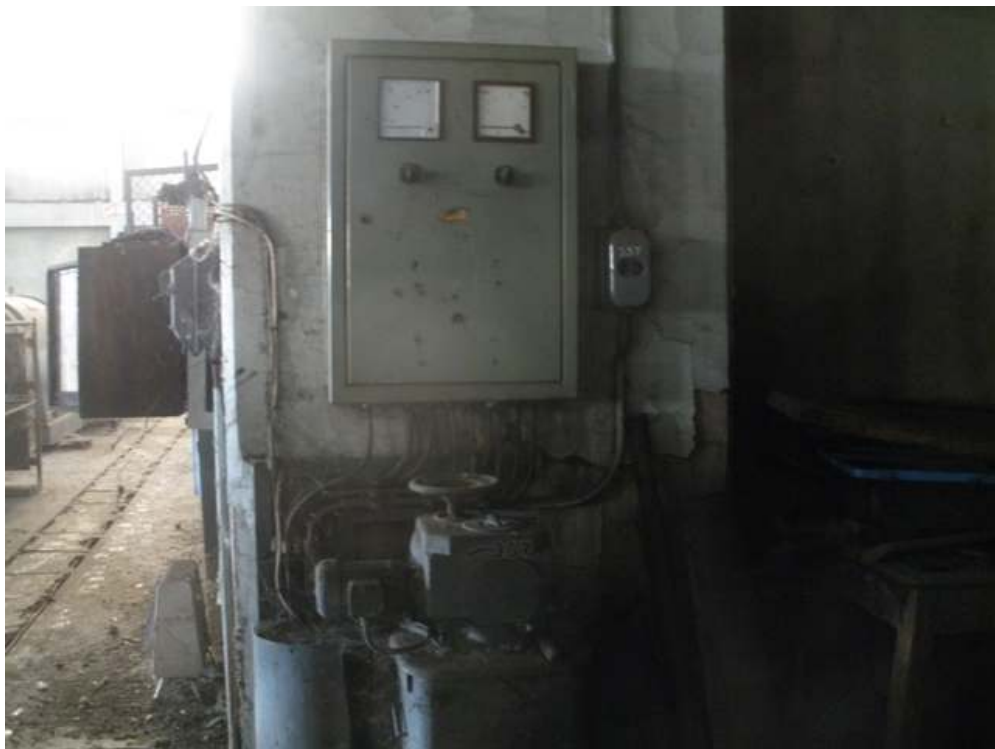
Φωτ. 118. Πίνακας εκκινήτη.
