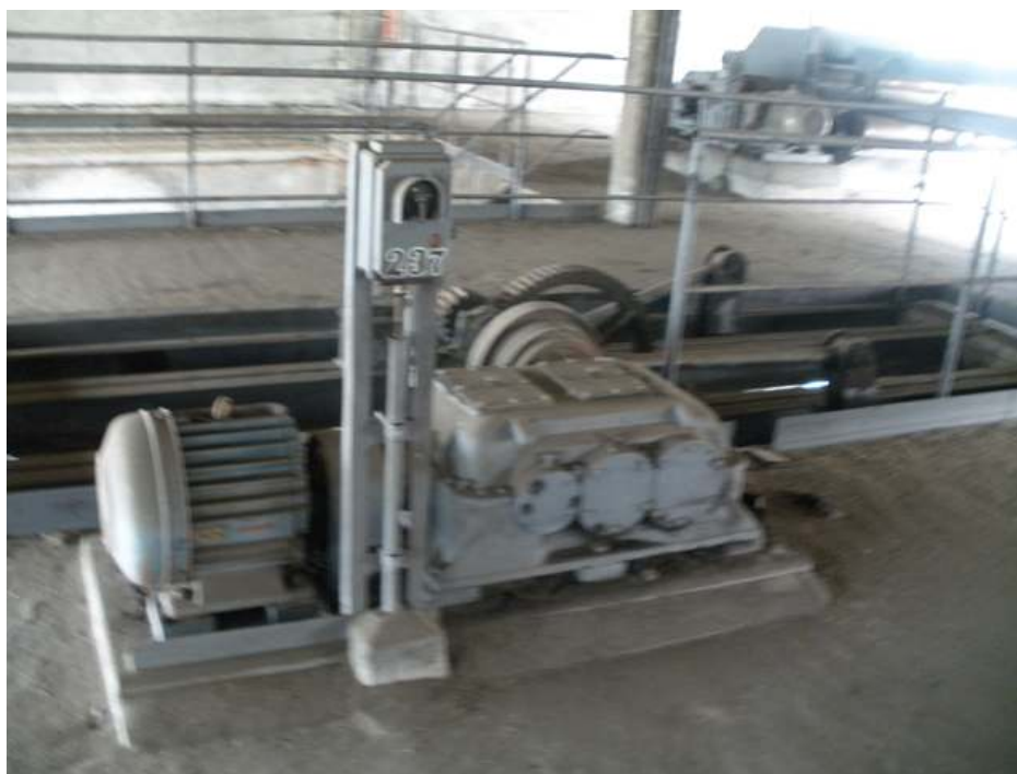
Φωτ. 60. Κόσκινο φυσικού λιγνίτη. Άνω τμήμα. Μηχανισμός κίνησης του ξέστρου. Ηλεκτροκινητήρας και γωνιακός μειωτήρας.
