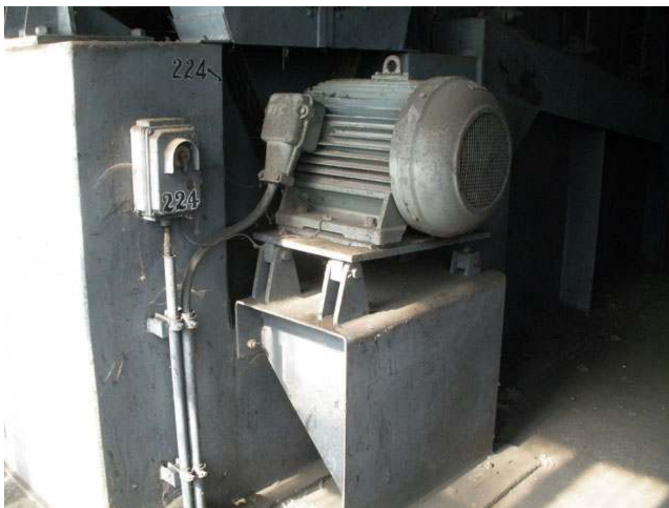
Φωτ. 68. Κόσκινο φυσικού λιγνίτη. Ηλεκτροκινητήρας.
