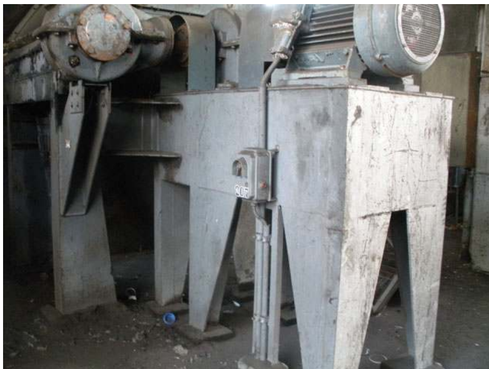
Φωτ. 103. Σπαστήρας φυσικού λιγνίτη. Βάση κινητήρα πρώτου σταδίου.
