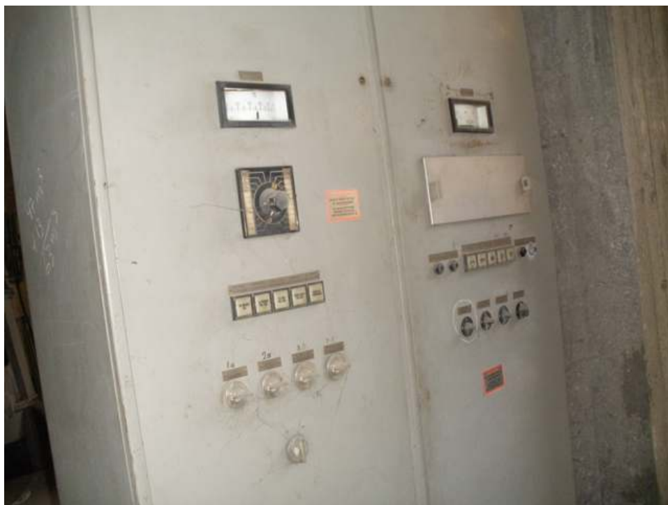
Φωτ. 53. Μηχανή παραγωγής Υδρογόνου, πίνακας ελέγχου.
