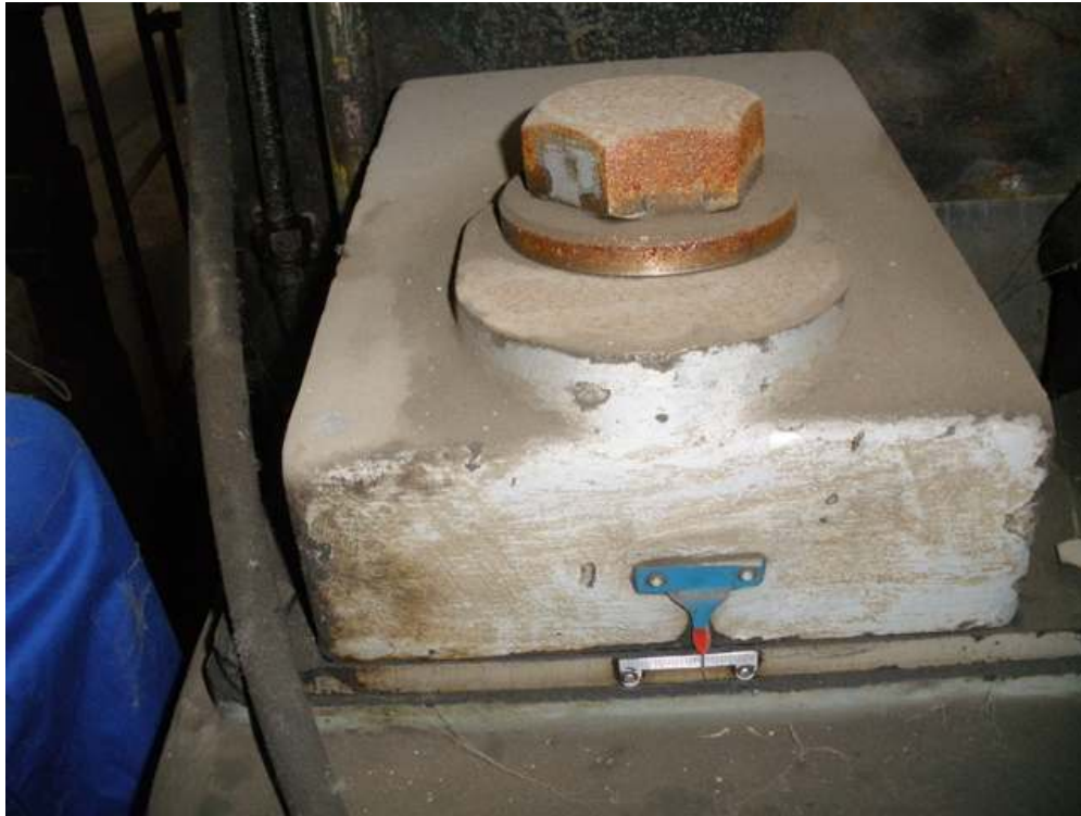
Φωτ. 39. Πέδιλο στροβίλου. Λεπτομέρεια δείκτη ρύθμισης διακένων κατά τον διαμήκη άξονα.
