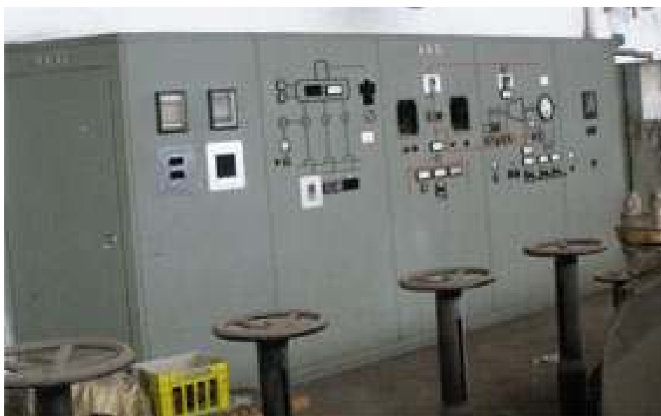
Φωτ. 44. Πίνακας ελέγχου ατμού, όψη στροβίλου.
