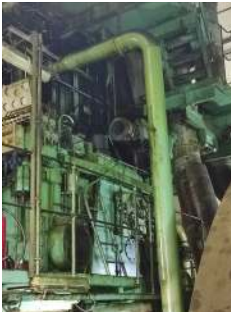
Μηχανή Diesel: Πλευρά Γεννήτριας
