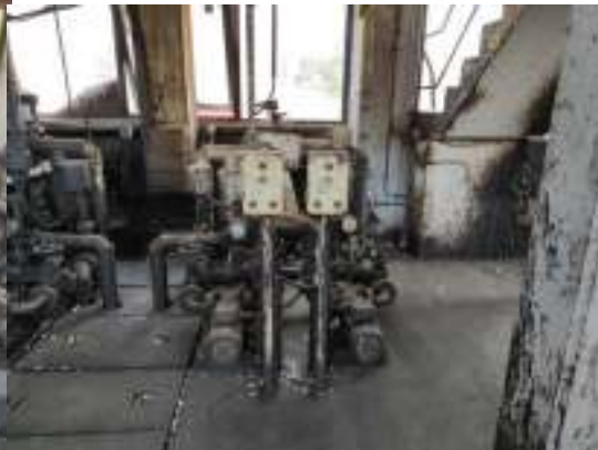
Μονάδα προώθησης καυσίμου προς την Μηχανή Νο4
