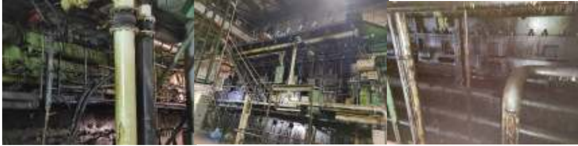
Μηχανή Diesel: Ανατολική πλευρά
