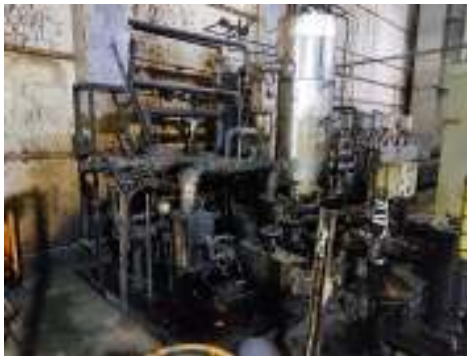
Τελικό αντλιοστάσιο Μηχανής DieselNo2
