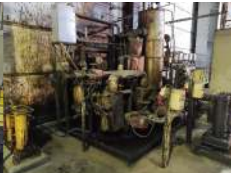
Τελικό αντλιοστάσιο Μηχανής DieselNo3
