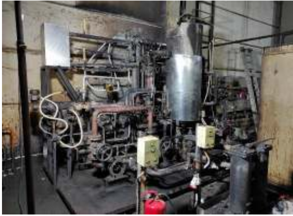
Τελικό αντλιοστάσιο Μηχανής DieselNo1
