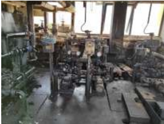
Μονάδα προώθησης καυσίμου προς την Μηχανή Νο1
