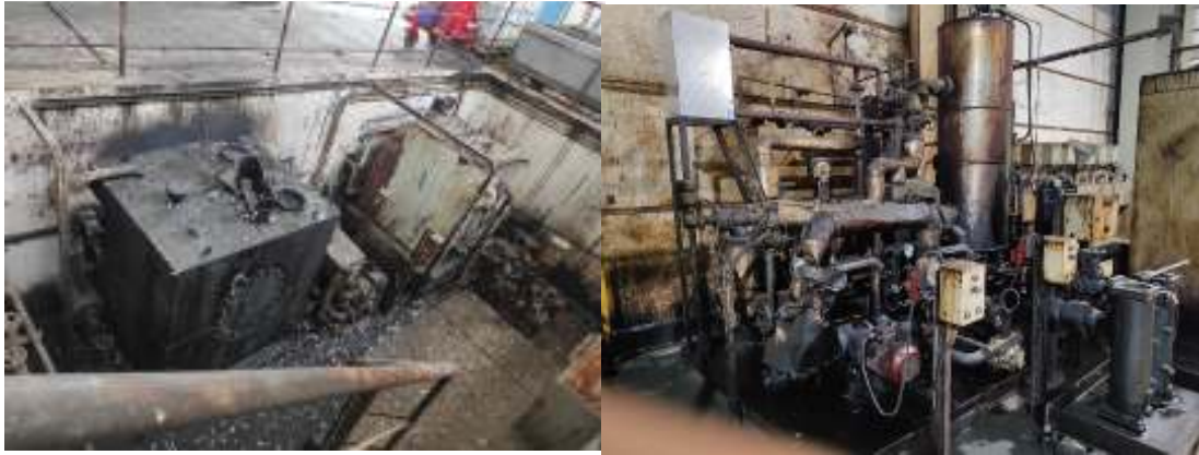
Αντλιοστάσιο καυσίμου: Βοηθητικές εγκαταστάσεις Τελικό αντλιοστάσιο Μηχανής DieselNo4
